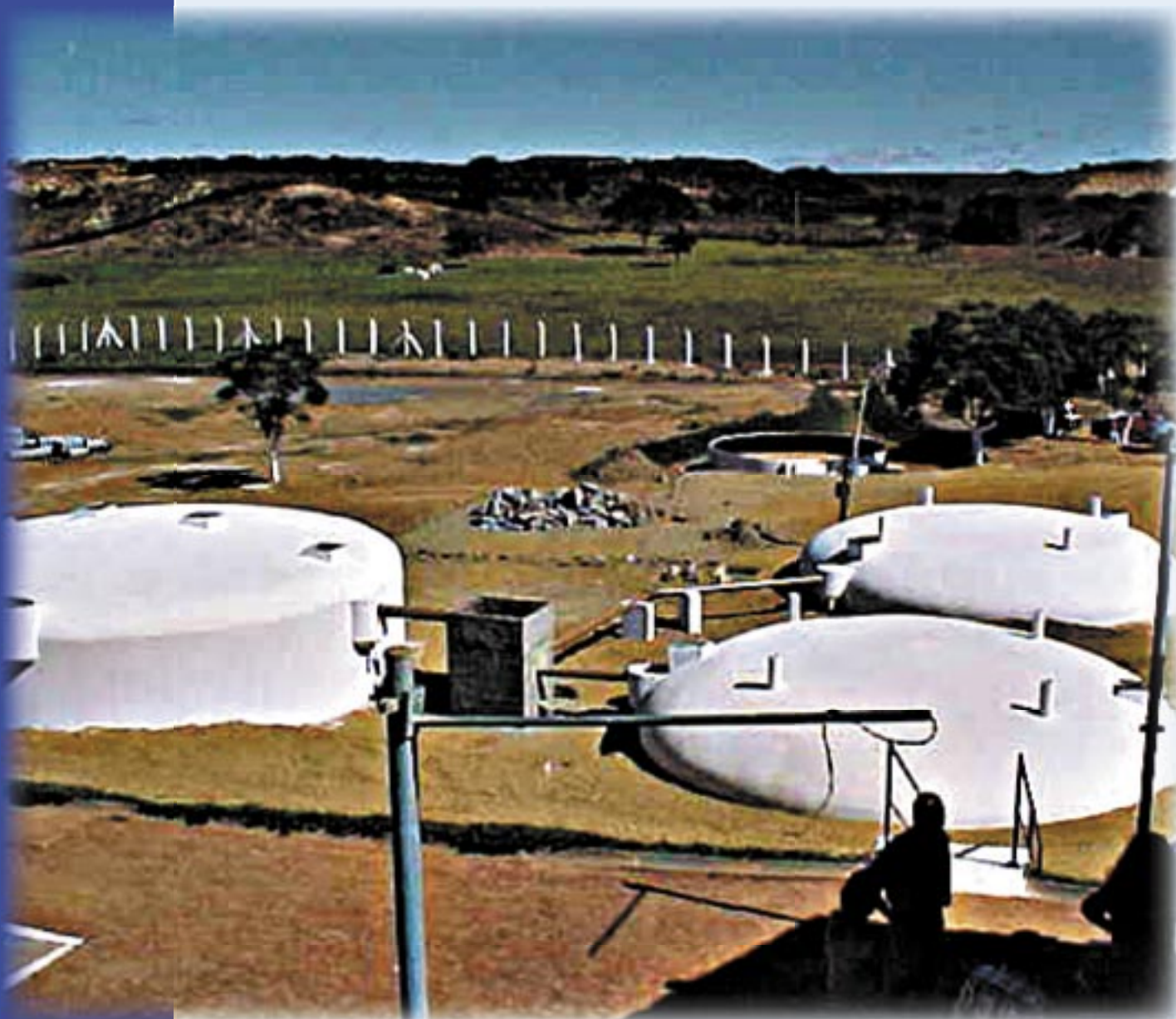
Estação de Tratamento de Esgoto - Sistema Águas Vermelhas - MG
