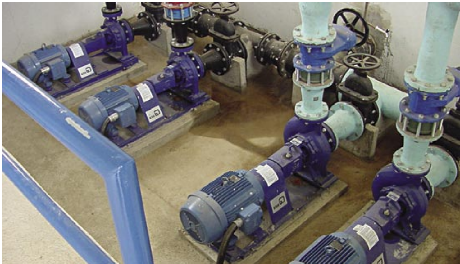
Estação Elevatória - Sistema Estrela de Alagoas - AL
