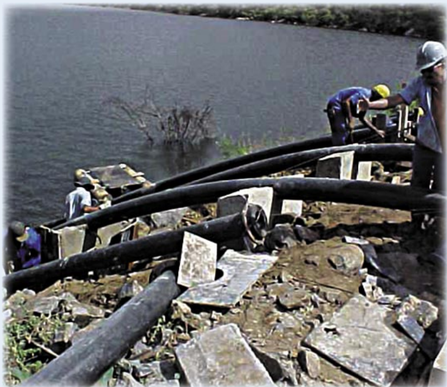
Captação - Sistema Adutor do Congo - PB
