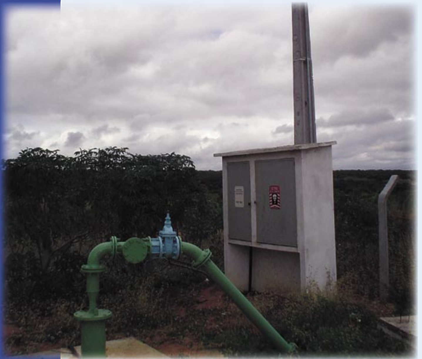
Poço do Sistema Afogados de Ingazeira - PE
