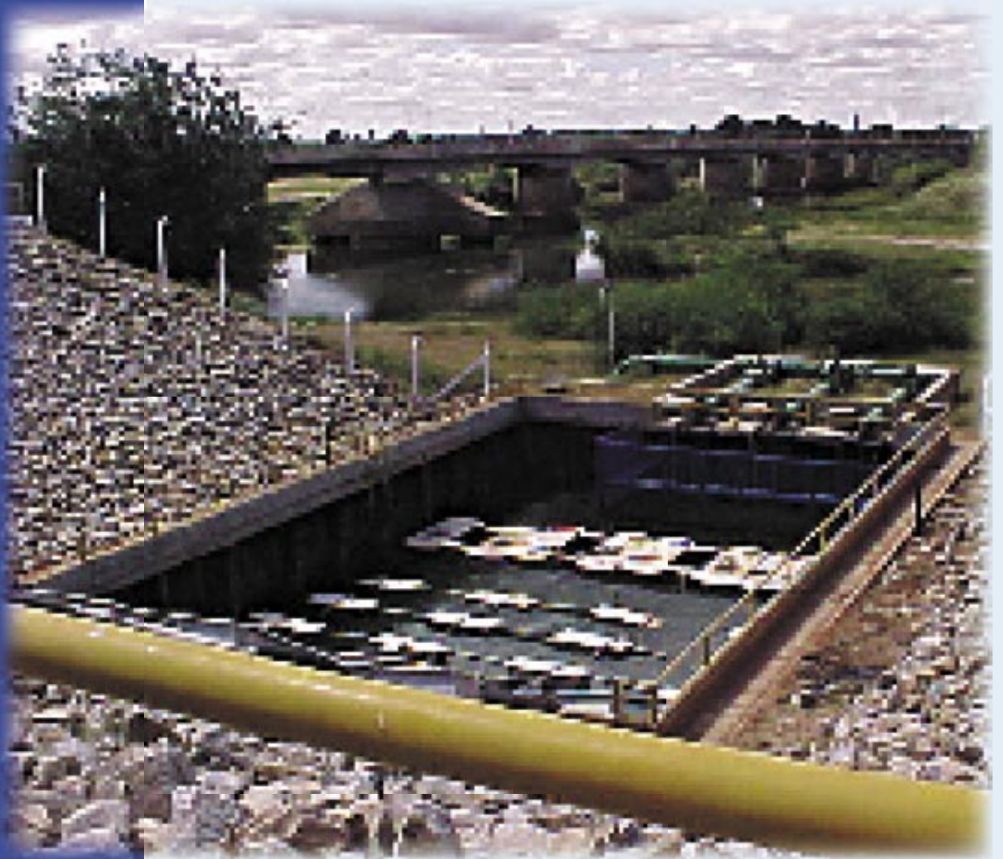
Captação da Adutora de Mossoró - RN
