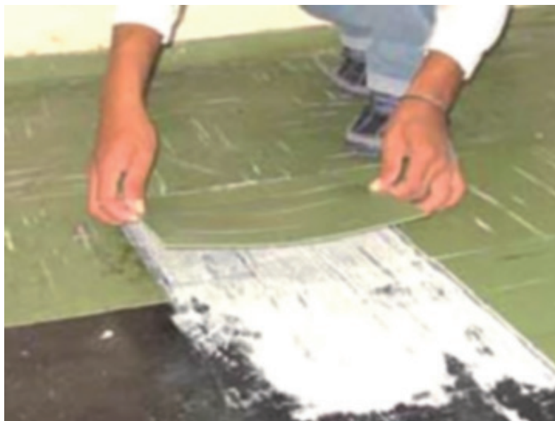
Aplicação de piso de borracha vinílica em placas. (Fonte: < http://www.adespec.com.br >. Acesso em: 26 set. 2007.)
