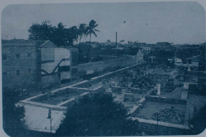
O estado actual das obras, para construção do Palacio da Justiça. Os trabalhos proseguem sem interrupção e em breve Pernambuco terá realizado mais uma velha e legitima aspiração qual seja a de instalar convenientemente, a sua justiça.
