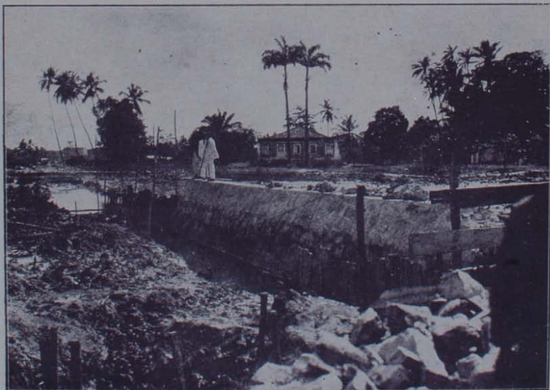
Construção de um trecho do canal que corta longitudinalmente a avenida "Paz e Trabalho"
