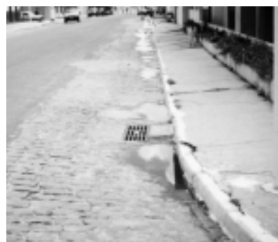
Sarjetas acidentadas dificultam a limpeza e a drenagem
