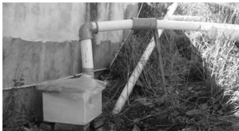
Figura 2 – Captação da água da chuva proveniente do telhado.
