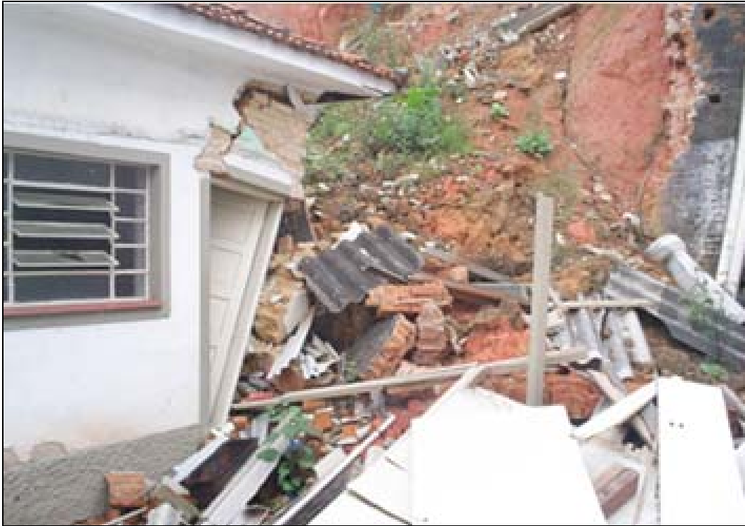
Fotografia 7 - Vista da edificação a jusante, atingida pelos materiais da erosão e dos escombros.
