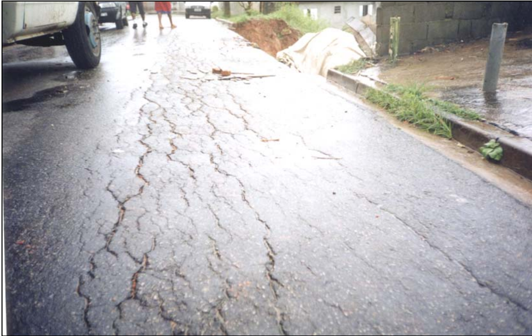
Fotografia 2 - Cicatrizes de escorregamentos e pontos de infiltração de água no leito asfáltico.
