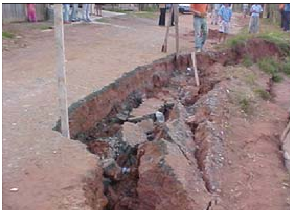
Fotografia 9 - Escorregamento em via pública. Fonte: SABESP, 2005.
