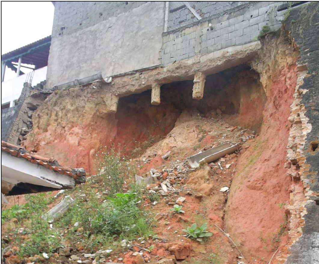
Fotografia 6 - Vista da erosão e precariedade de infra-estrutura sob a edificação da Rua Ari Bouzan.
