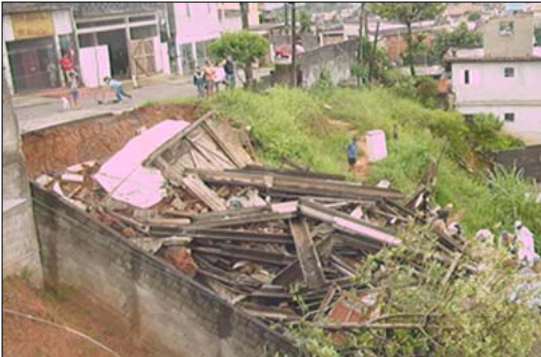
Fotografia 3: Erosão do passeio cimentado e desligamento da tubulação de água.
