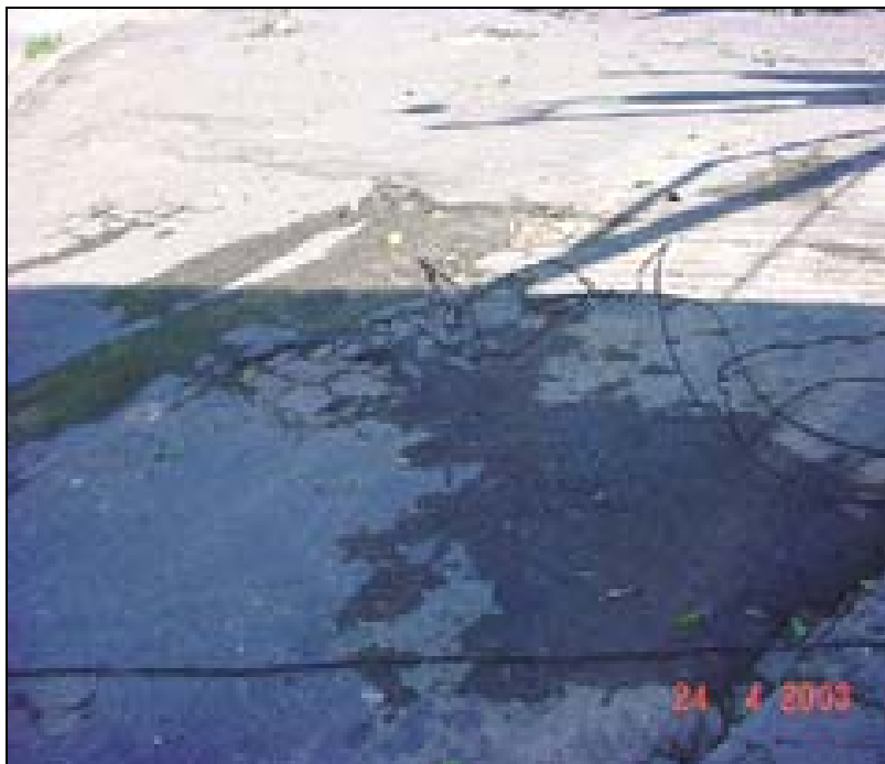
Fotografia 12 - Vazamento aflorante na Rua Dorneles. Fonte: IPT, 2003.
