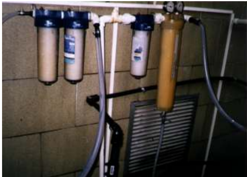
Fig. 11 - Sistema de purificação com 3 pré-filtros e um ultrafiltro
