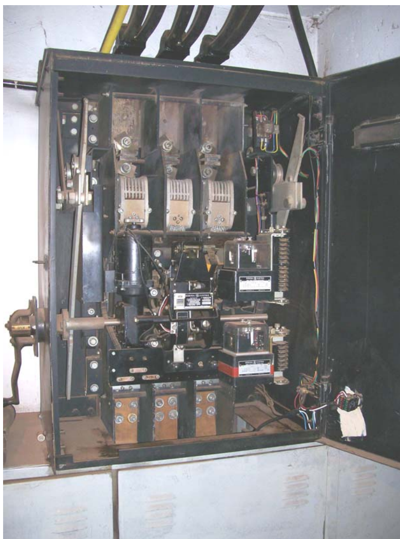
Figura 2.2.1.2: Protetor de Redes General Electric modelo MG9 de 1200A@380V, instalado em 1970 na Companhia Energética de Brasília. Fonte: foto cedida por João Carlos dos Santos, gerente CEB do P&D1616. 2009.
