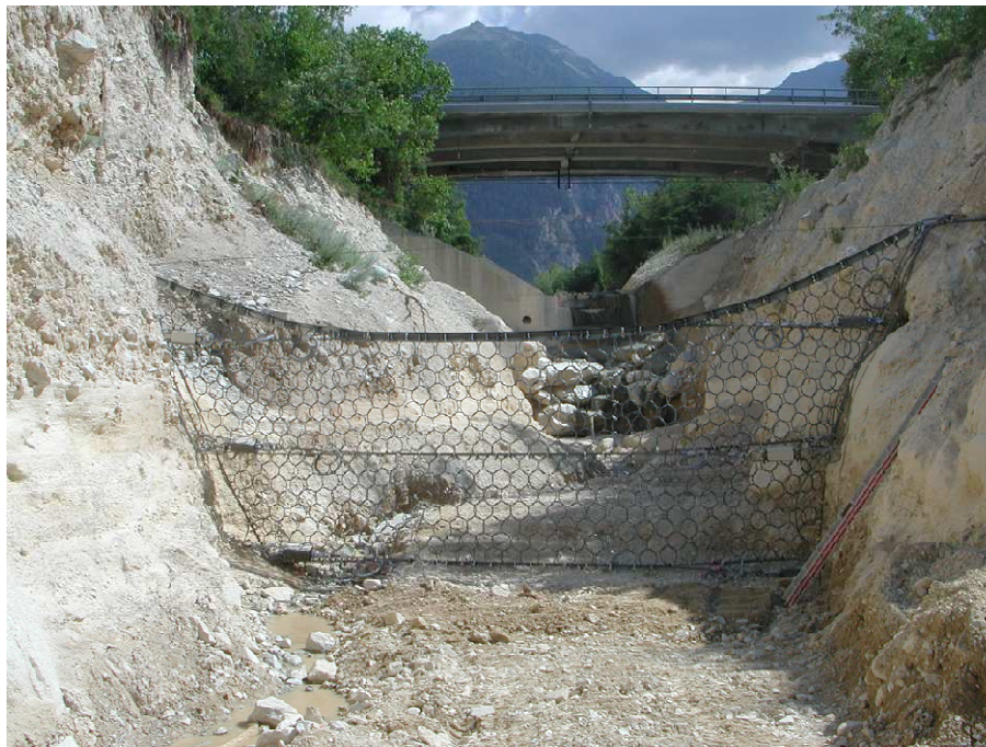
Figura 3.24 - Barreira flexível para teste, Illgraben (WENDELER et al. , 2006).
