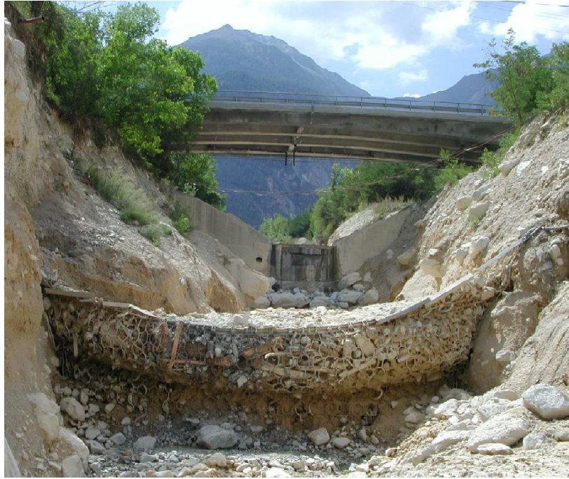
Figura 3.25 - Barreira de teste no Illgraben , após evento de fluxo de detritos (WENDELER et al. , 2006).
