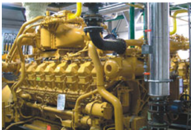
Figura 5.1 - Foto grupo moto-gerador da central de cogeração
