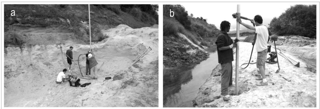
Figura 12: Preparação da sondagem com vibro-testemunhador, (a) pontos S01 e (b) S03, areal da Ilha III, região de Paranaguá.
