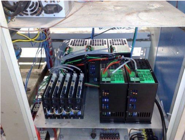
Figura 4.11 – Controladoras EPOS 70/10 e fontes de alimentação (maiores) dos motores, 48 V, instaladas na bancada protótipo.
