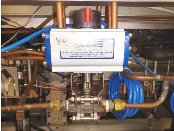
Figura 4.8 – Válvula esfera acionada por atuador eletropneumático, instalada na bancada.
