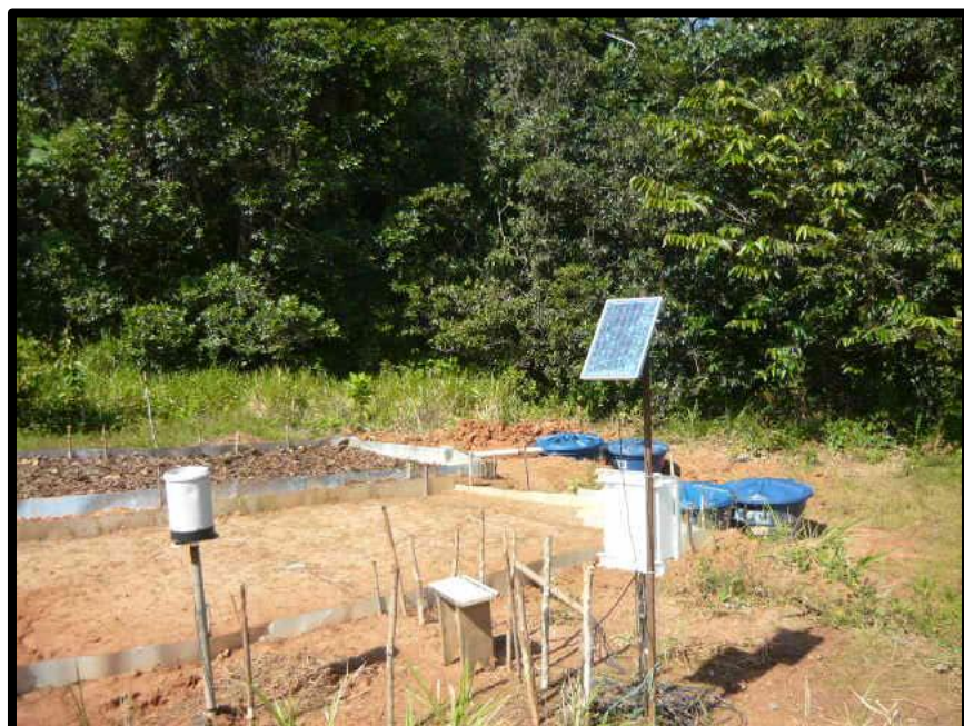
Figura 21. Pluviômetro e datalogger (CR23X Campbell - EUA) alimentados por painel solar, instalados na Jazida 21.
