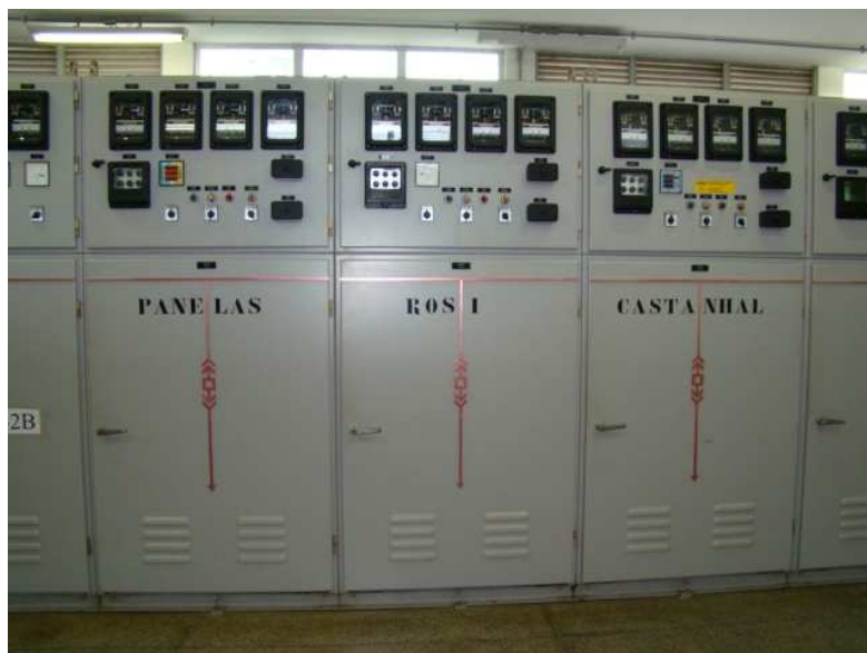
Figura 4.2 – Foto dos painéis de 13,8 kV dos alimentadores de Painelas, Rosário I e Castanhal.
