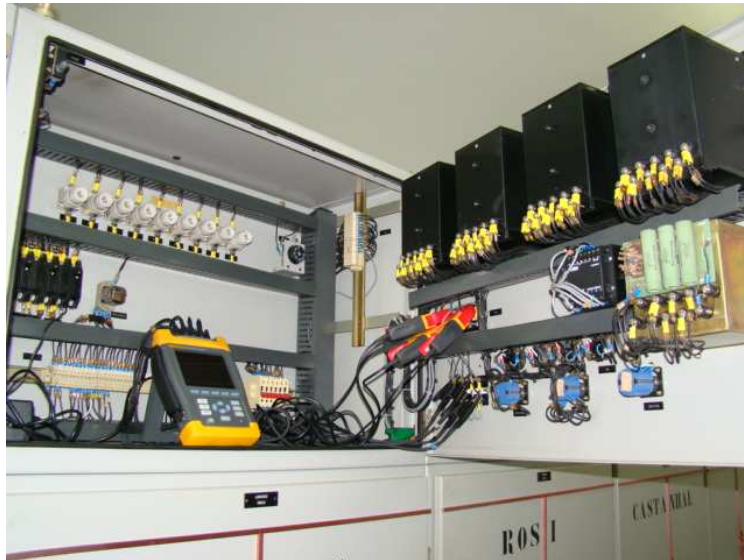
Figura 4.4 – Instalação do Fluke para as medições
