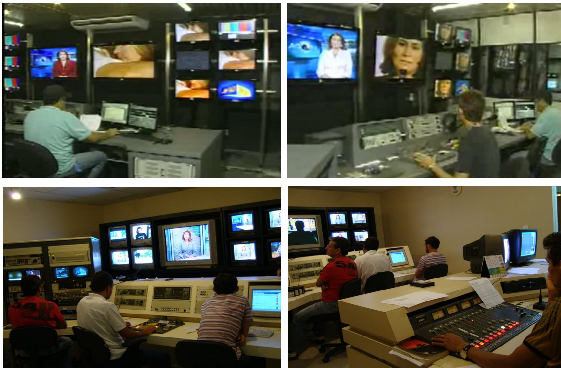
Fig. 21: Switcher . Acima, as instalações da TV Cabo Branco (imagens: reprodução de TV). Abaixo, a estrutura da TV Paraíba, durante a exibição do JPB-1 de 26/03/2009. Imagens: Pesquisador.
