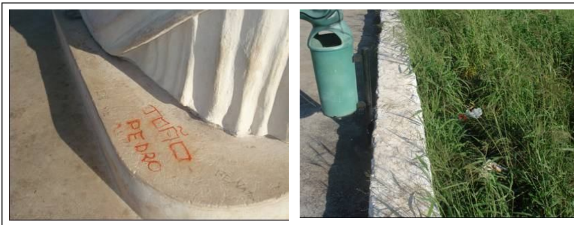
Figura 19. Aspectos da má conservação no Cristo Rei do Pantanal
