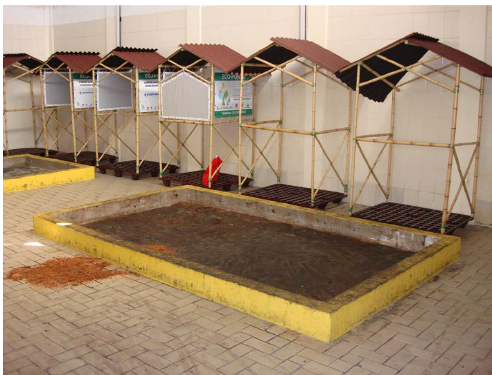
Figura 10 – Galpão ONG mostrando estrutura dos Ecopontos e bacia de contenção de derramamentos.
