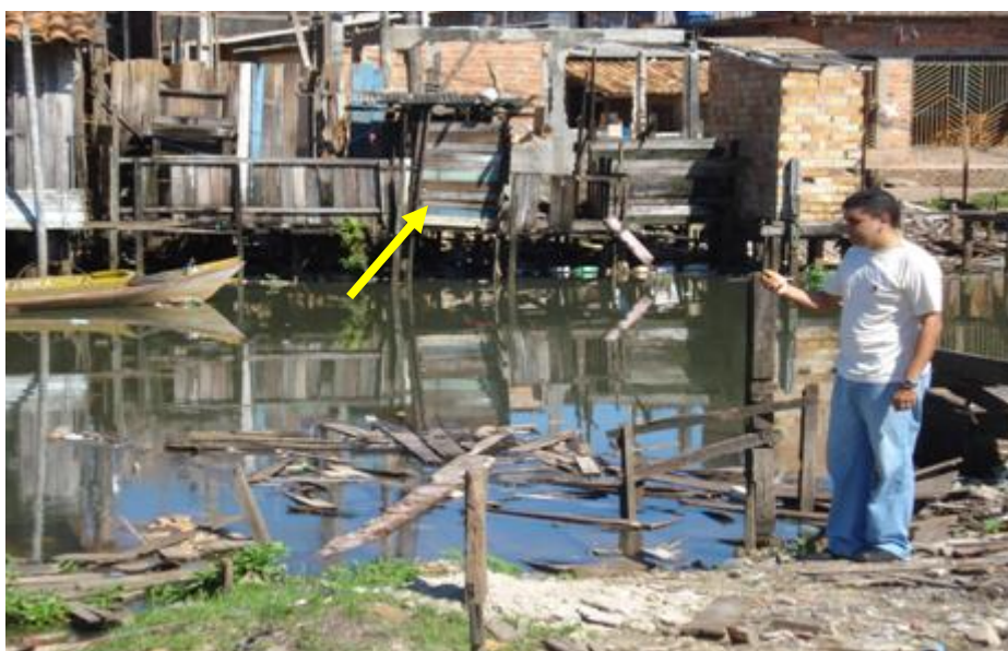
Figura 38. Observa-se uma unidade sanitária sobre o curso de água, situada nas coordenadas geográficas 01° 27' 40" S, 48° 27' 22" W.
