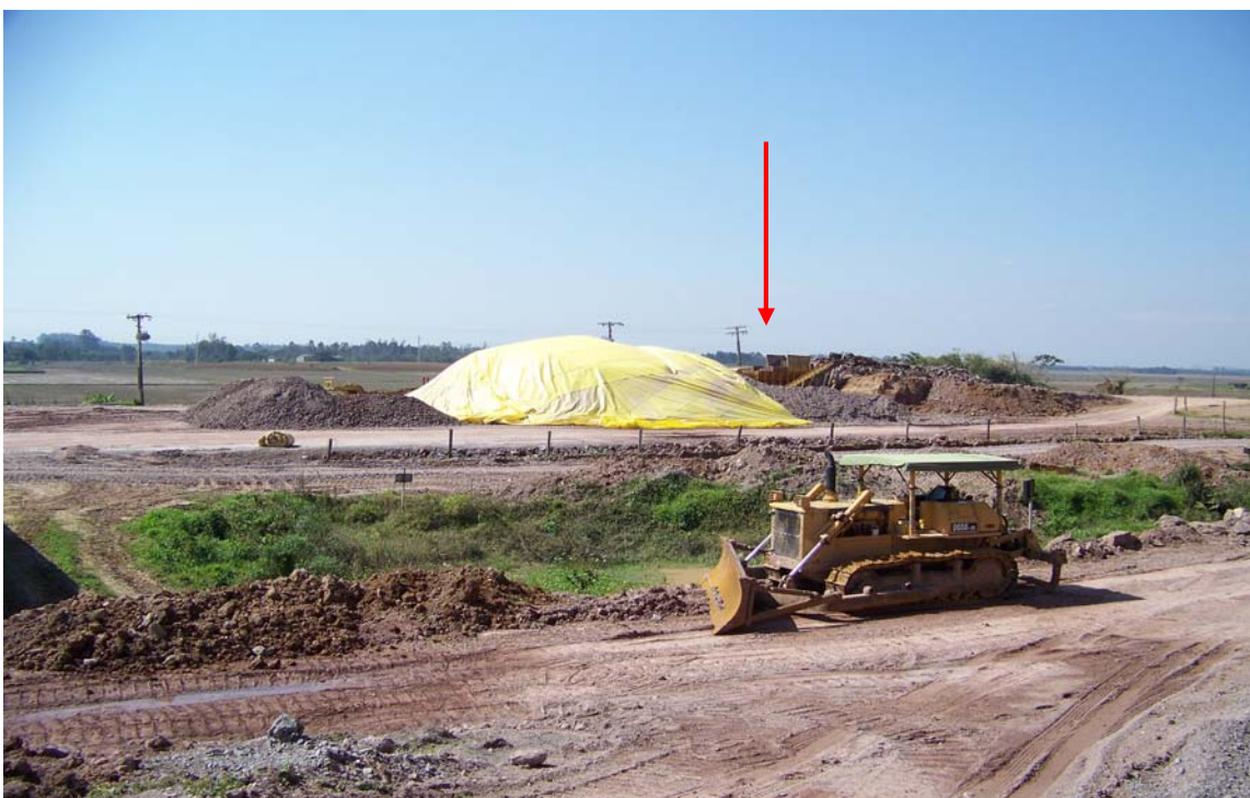
Figura 2 - Trator de esteira de lâmina frontal e escarificador na traseira, o britador ao fundo da fotografia (seta) e o lote de material em descanso sob a lona amarela. Área de manuseio do material da mina de Turvo.
