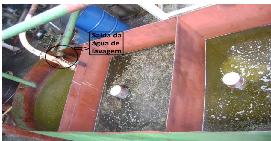
Figura 7 Tanque de retenção de gordura.
