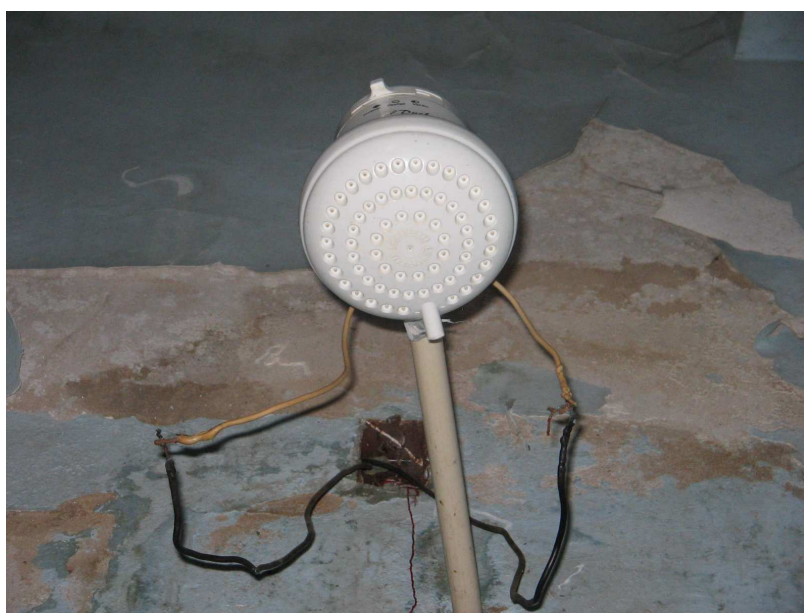
Fotografia 22 – Chuveiro Autoria: Vale (2007)
