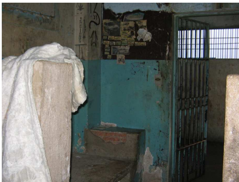
Fotografia 11 – Alojamento sem ventilação e sem entrada de luz solar Autoria: Vale (2007)
