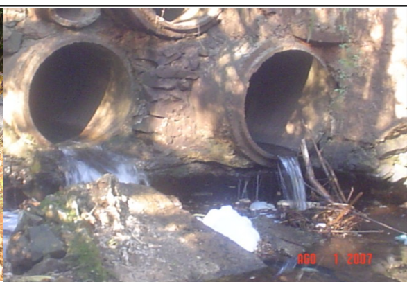
Foto 11 – Lançamento clandestino e irregular de efluentes líquidos sem tratamento no Ribeirão Mandacaru na zona sete, por empresas localizadas nas proximidades da Av. Colombo.
