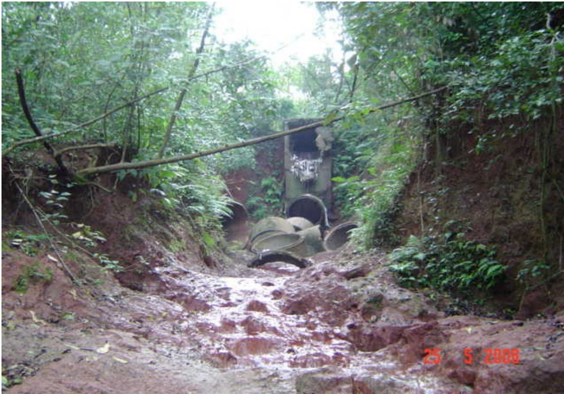
Foto 45 – Tubulações destruídas pela força das águas pluviais no interior do Horto Florestal. Fonte SEMA/2007.
