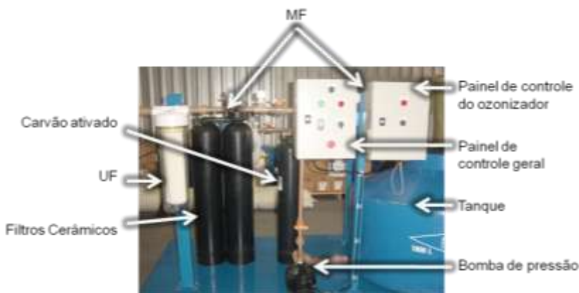
Figura 5-1: Foto da planta piloto.
