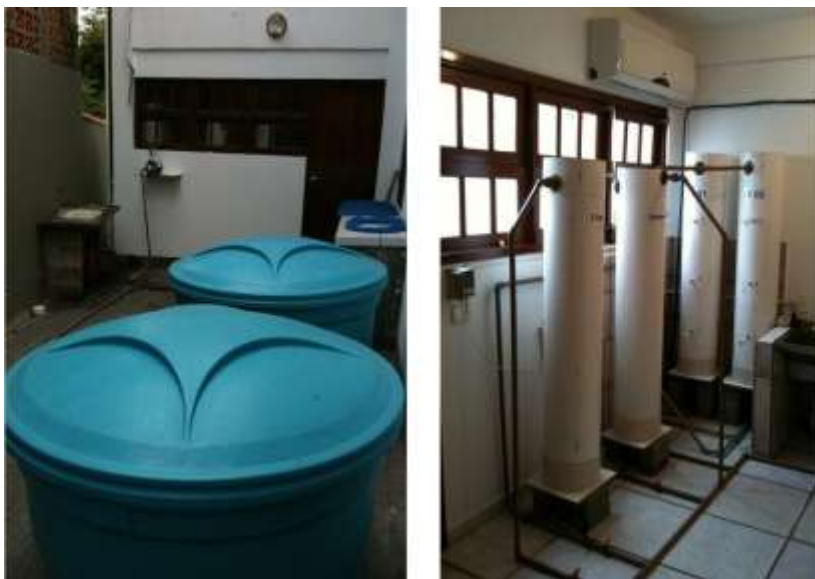
Figura 14 – Fotos da planta piloto de desnitrificação biológica
