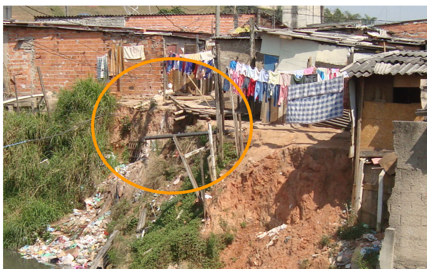
Fotografia 9 – Perfil da ocupação das margens, o processo de erosão consome os barracos em suas bordas.
