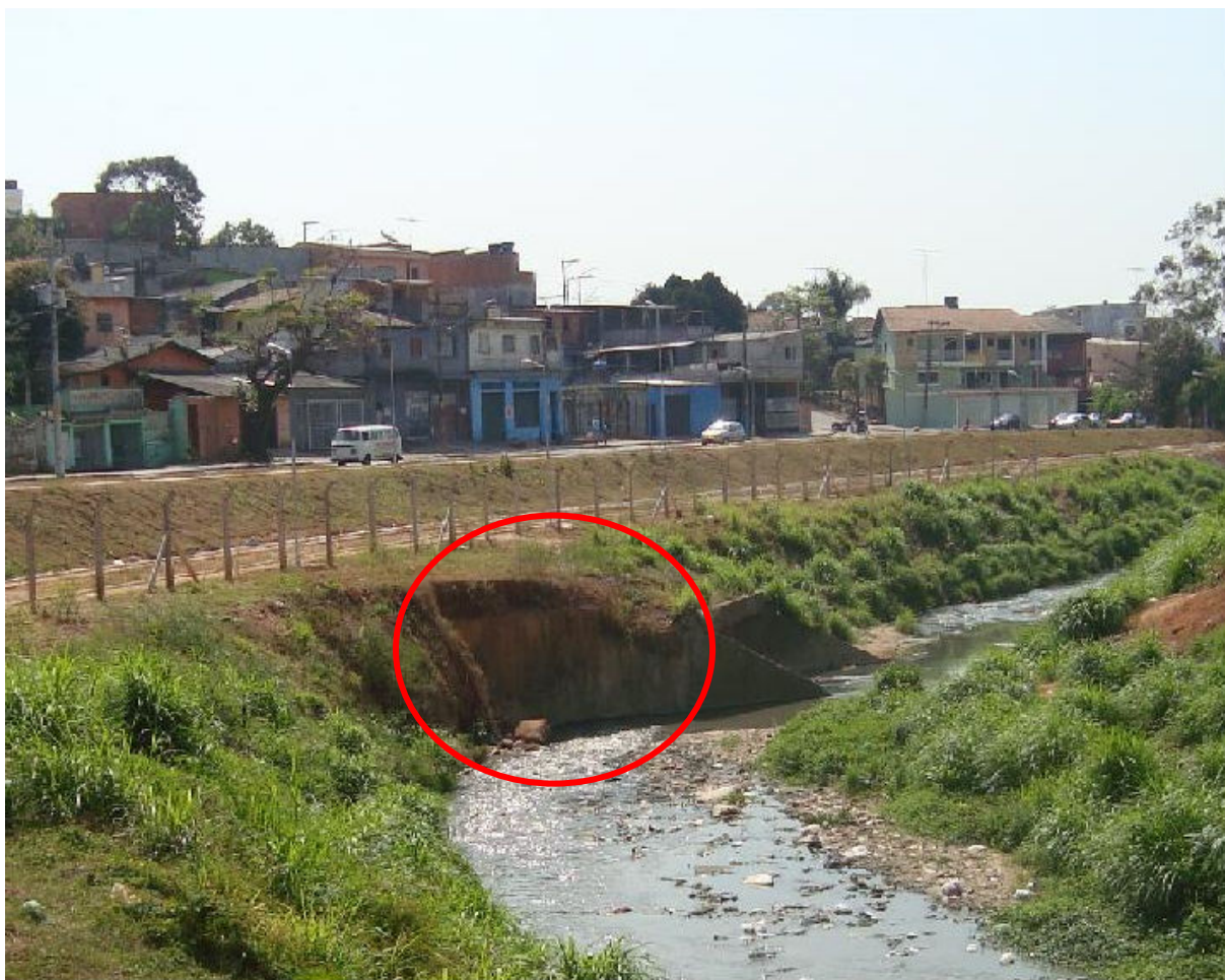
Fotografia 7 – Erosão das margens do córrego Rio Verde.
