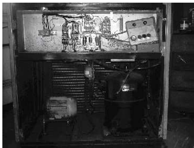
Figura 3.2 - Fotografia do aparelho de ar condicionado tipo self-contained da marca Hitachi, utilizado inicialmente na presente pesquisa.
