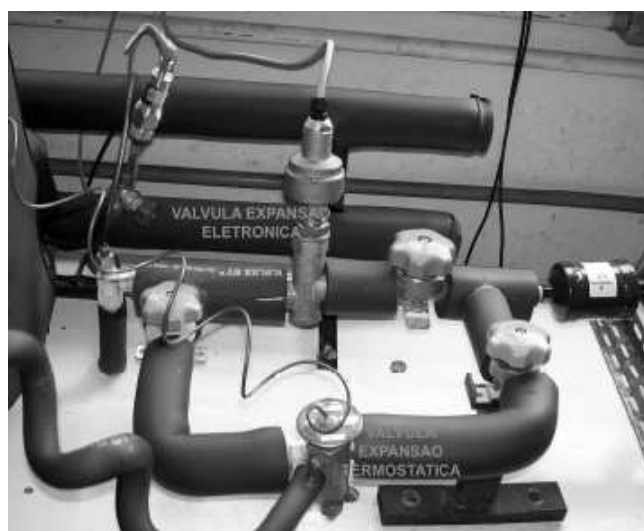
Figura 3.6 - Detalhe da seção, ilustrando o by-pass entre a válvula de expansão eletrônica (VEE) Danfoss ETS25 e válvula termostática (VET), no circuito principal de refrigeração.
