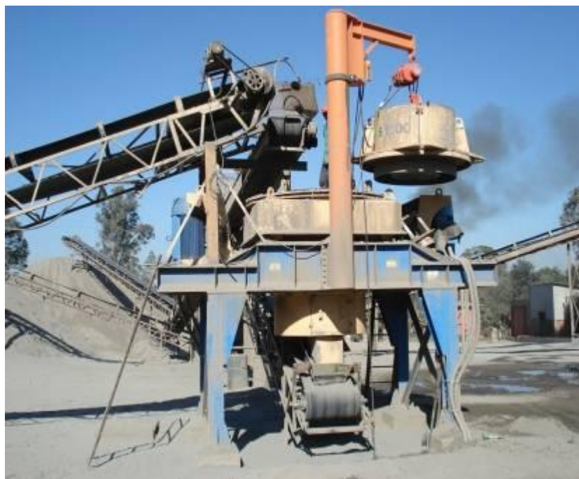
Figura 29 – Britador V. S. I. desmontado para manutenção Fonte: Do autor (2009).
