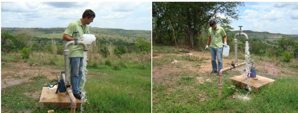
Figura 19 Poço PT2 do Assentamento Zumbi do Palmares, distrito de Ente Rios, Dom Aquino.
