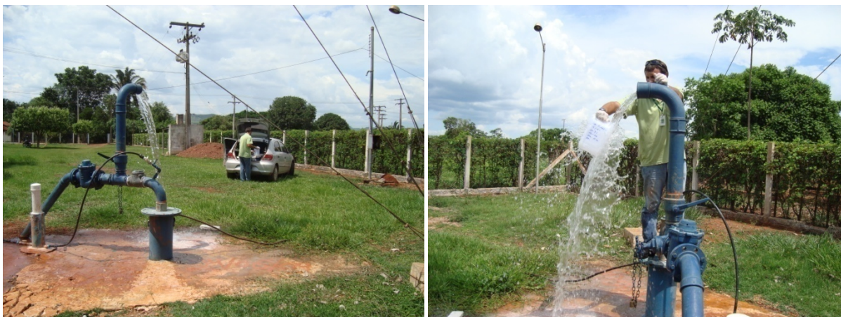
Figura 22 Poço PT2 DAE Dom Aquino, cidade de Dom Aquino.
