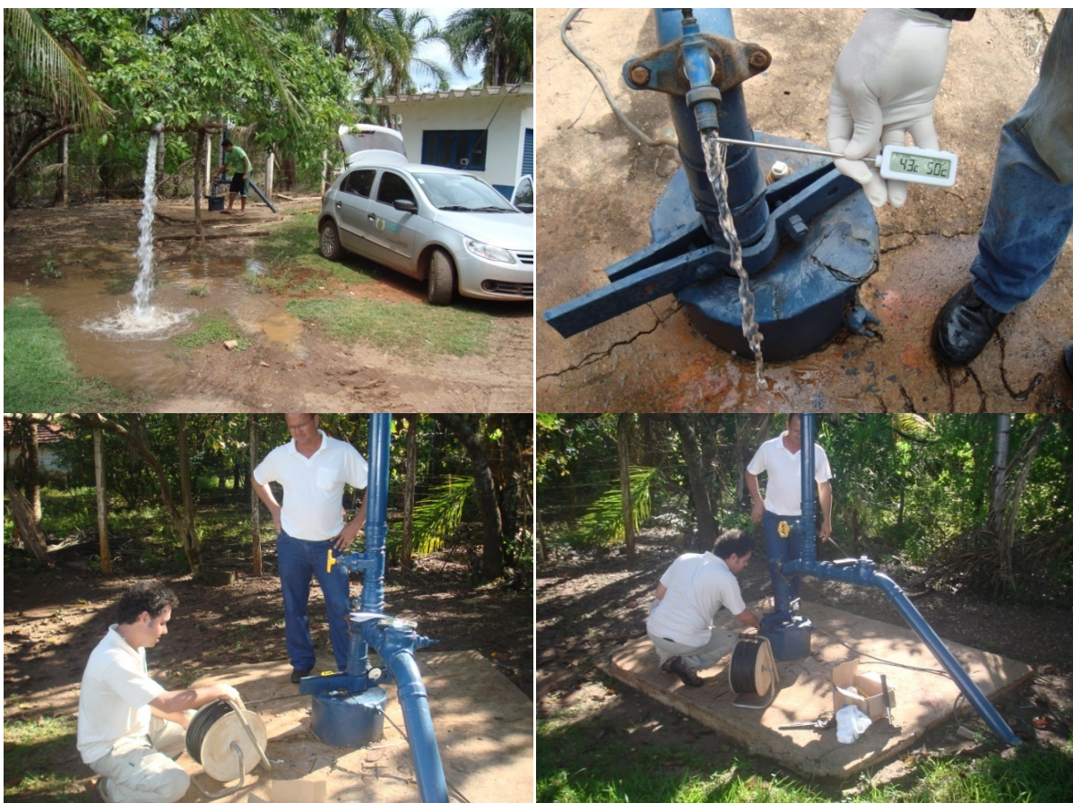
Figura 20 Poço do DAE Dom Aquino, distrito de Entre Rios
