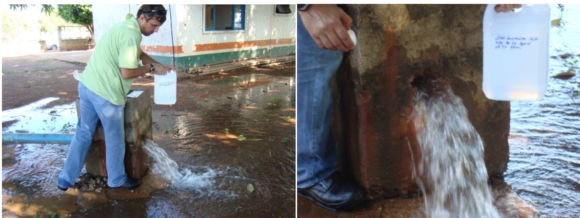
Figura 10 Poço PT1 do DAE Juscimeira.
