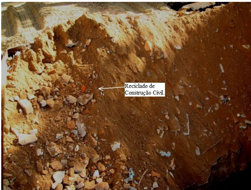
FIGURA 5.23: Reciclado de construção Civil antes de ser colocado na vala - Vala Exp. 2.
