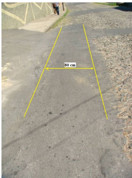
FIGURA 4.104 – Situação atual da vala 4 após dez meses de tráfego.
