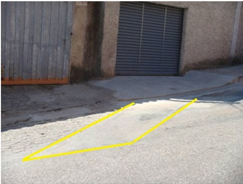
FIGURA 4.105 – Situação atual da vala 5 após 10 meses.
