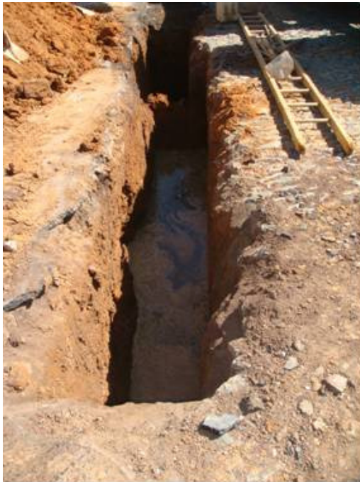
FIGURA 4.53 – Reparo da rede de esgoto, fundo da vala com material saturado – Vala 4.
