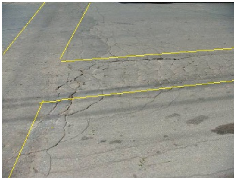
FIGURA A2.6 - Novas intervenções, abatimentos e trincas – Rua Léa Vitor esq. c/ Av Tancredo Neves.
