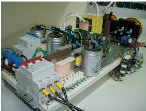
Figura 5.49: Vista da entrada CA do protótipo.
