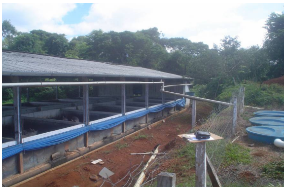
Figura 21 – Canos de captação de água da chuva para armazenagem e cisterna – Concórdia – SC
