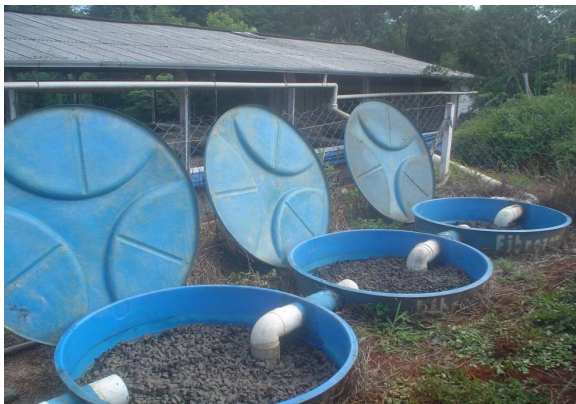
Figura 22 – Cisternas de filtragem de captação de água da chuva vindas de calhas de granjas de suínos – Concórdia – SC
