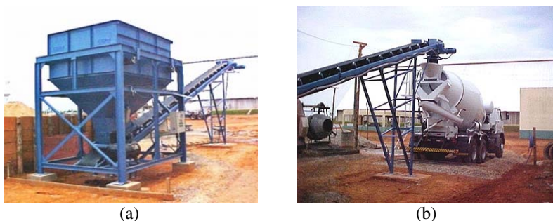
Figura 8 – Central “Tow go”: (a) balança; (b) correia transportadora e caminhão betoneira [CSM, 2009].
