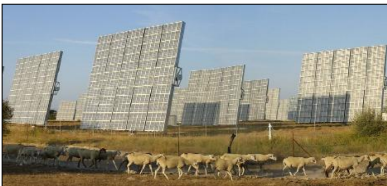
Figura 2.29 – Parte da planta fotovoltaica de 12 MW N , com SFVC Guascor, instalada em Villafranca, Espanha.
