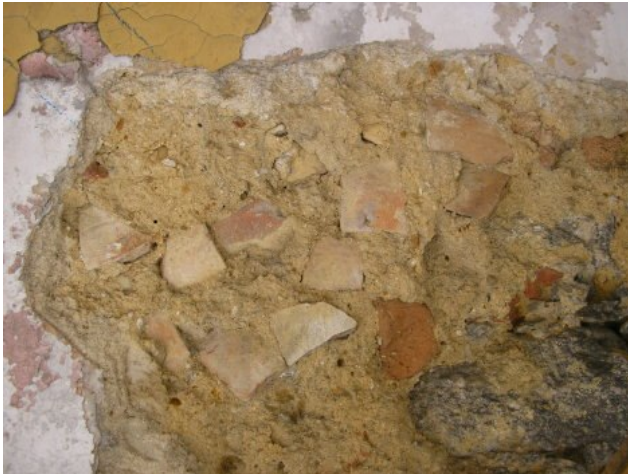
Figura 40: Cacos de telha colonial empregados para preencher volume na argamassa, junto à abertura N14
