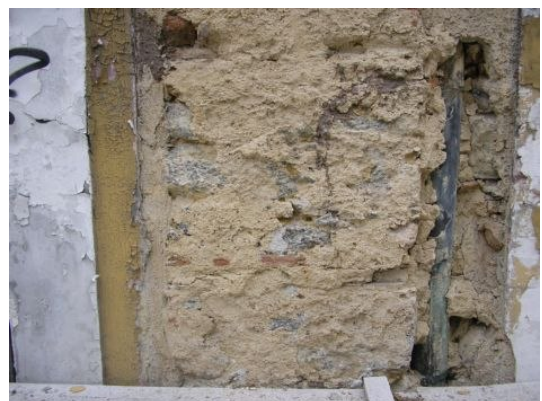
Figura 58: N13 - Tubo de queda em cobre (à direita), exposto pela perda de material da pilastra
