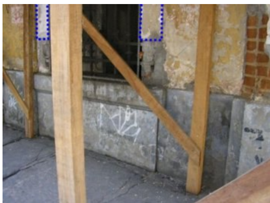
Figura 57: WS13 - Pedra de cantaria (indicada pelo pontilhado) interrompida 42,5cm acima do peitoril
