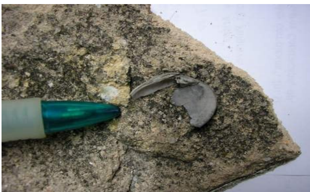
Figura 35: presença de agregado biogênico em argamassa desprendida da Fachada Central, porção central
