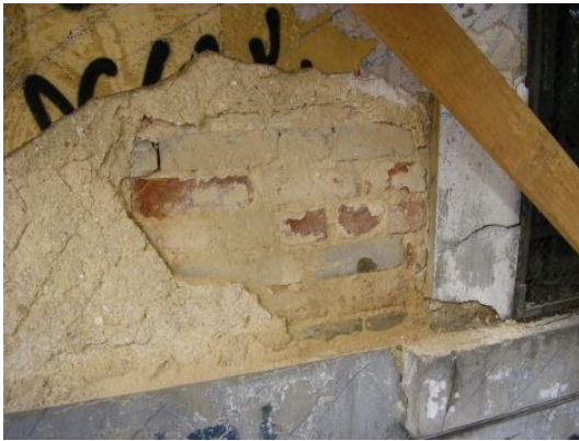
Figura 52: WN13 - Presença de alvenaria ao lado da janela, indicando a redução do vão de uma antiga porta mais larga
