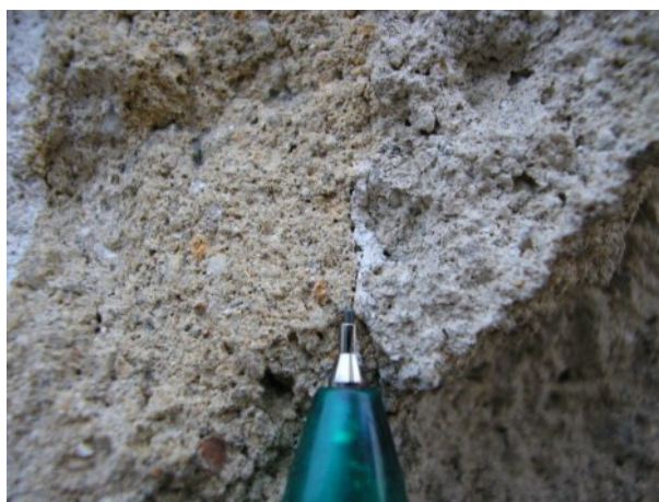
Figura 88: Detalhe da separação entre duas argamassas na pilastra WN27, uma mais branca e uma alaranjada
