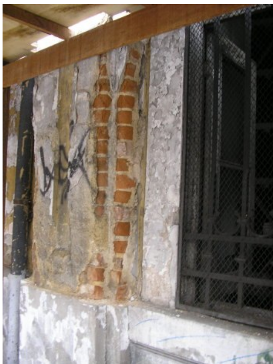
Figura 39: Pilastra com tijolos expostos (N16)
