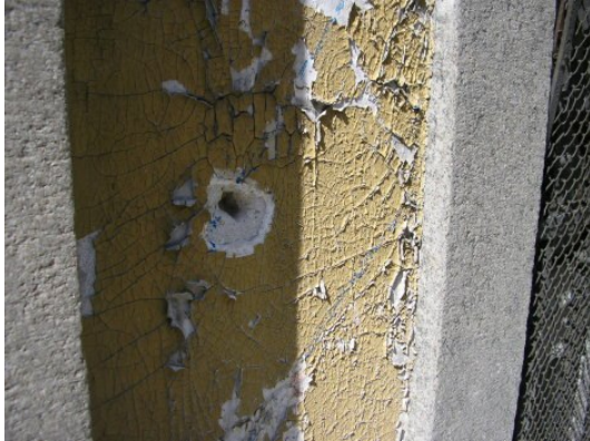
Figura 85: Vista de furo existente na argamassa próximo a WW13 (Fachada Central). Sob a pintura há uma argamassa de emboço muito alva
