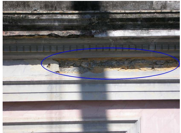
Figura 36: Substrato de pedra exposto pela perda da argamassa por influência da umidade
