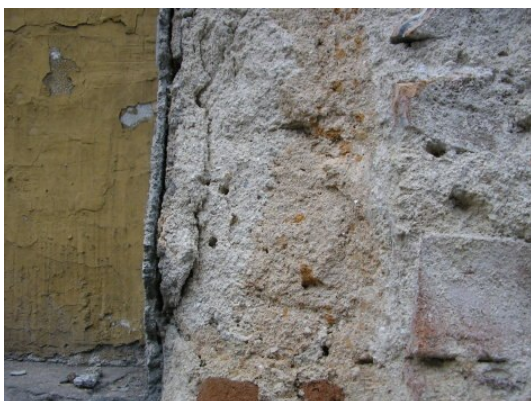
Figura 87: A degradação de uma pilastra expôs camadas de argamassa em WN27
