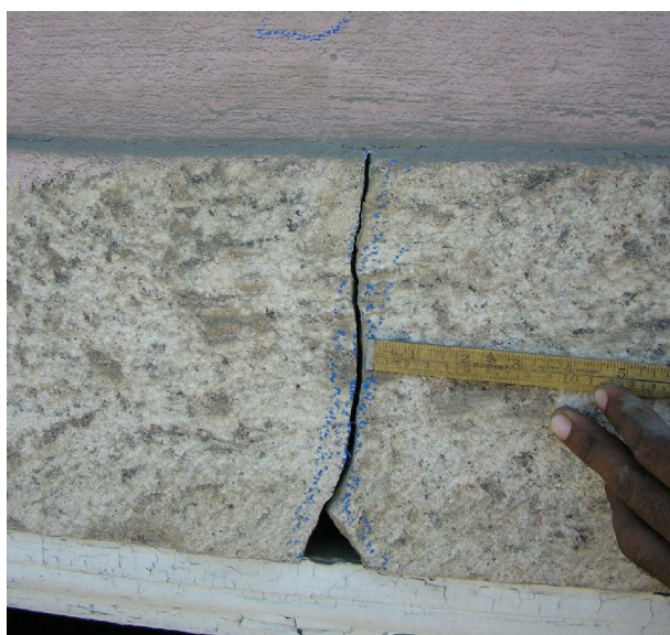
Figura 37: Fratura na verga em cantaria da abertura TN-E-23
