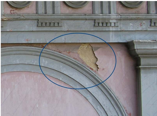
Figura 34: Argamassa de emboço exposta pela perda de reboco, junto à abertura TN-S-21
