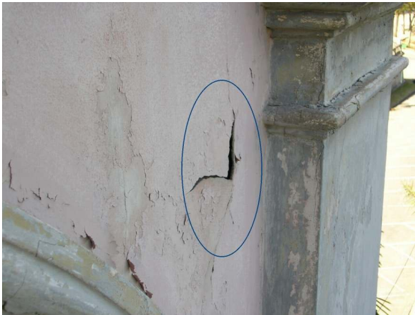
Figura 33: Detalhe de uma erupção do reboco, junto à abertura TS-S-25
