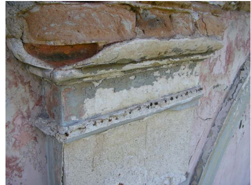
Figura 31: detalhe de um capitel sem a argamassa de acabamento, deixando à mostra os tijolos que constituem sua volumetria
