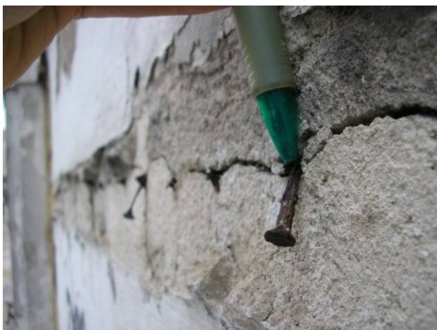
Figura 46: Friso perdido junto à janela N29, onde restaram à mostra cravos empregados como armação, muito oxidados
