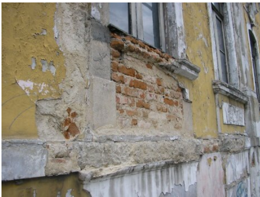
Figura 54: N27 – Alvenaria fechando vão de antiga porta-balcão. À esquerda, cantaria da porta indo até a laje de pedra do balcão, que foi cortada
