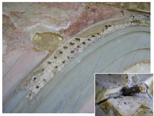
Figura 28: Detalhe do friso sobre a abertura TS-S23, onde a perda de argamassa deixa à mostra os cravos que servem de estrutura. Em detalhe, um cravo, com seção quadrada, em ferro forjado
