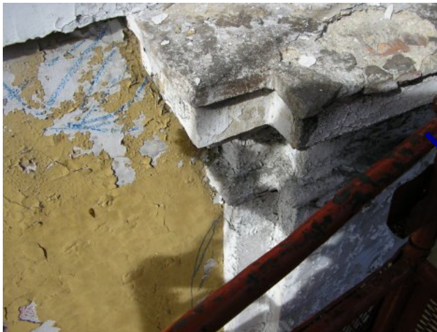
Figura 42: Parte superior da pilastra junto à WN23, onde a argamassa ausente permite ver um caco de telha marselhesa
