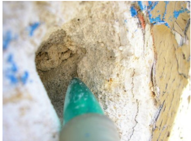
Figura 86: Detalhe do furo em profundidade. A caneta indica a separação entre duas camadas de emboço
