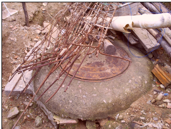
Figura 32 - Esgoto do Loteamento José Nitro lançado no Loteamento Morar Bem
