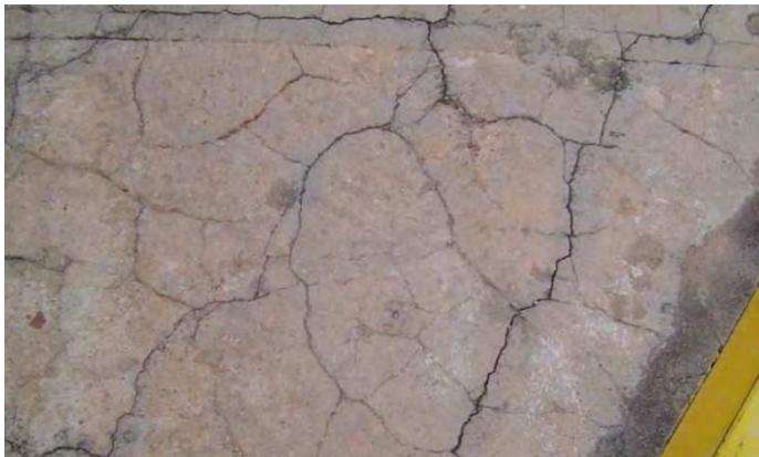
Figura 1 – Fissuras em forma de mapas no piso da tomada d'água da UHE Paulo Afonso III (SILVA, 2007).
