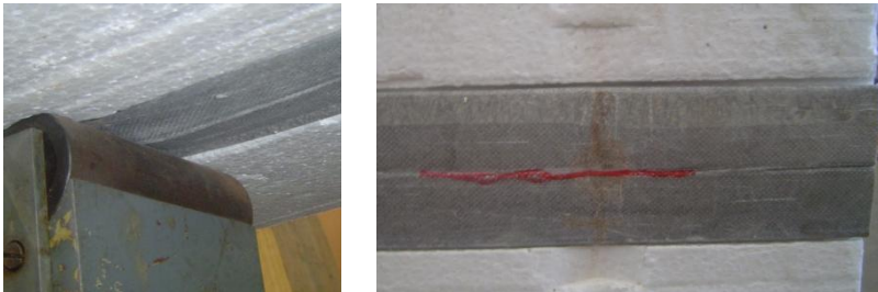
Figura 3.17 – Ruptura local na região do apoio do V2
