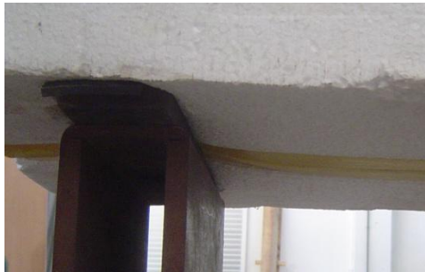
Figura 3.19 – Deformação excessiva no apoio do V1
