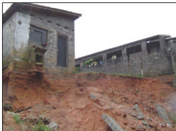
Foto 18 – Detalhe da ruptura de um aterro nos fundos de uma moradia na cidade de Tapiraí.
