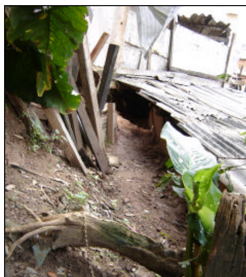
Foto 11 – Observar que parte da lateral e os fundos da moradia encontram-se em contato com o talude de corte.
