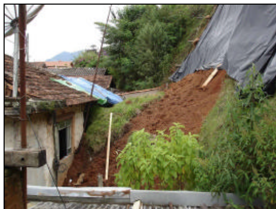
Foto 20 – Detalhe do volume de material mobilizado na ruptura de um corte.
