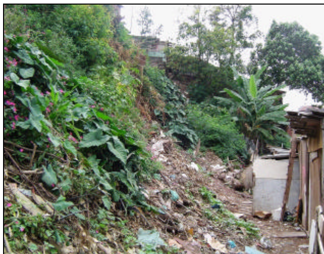
Foto 13 – Detalhe da alta declividade do talude e da proximidade de sua base às moradias.
