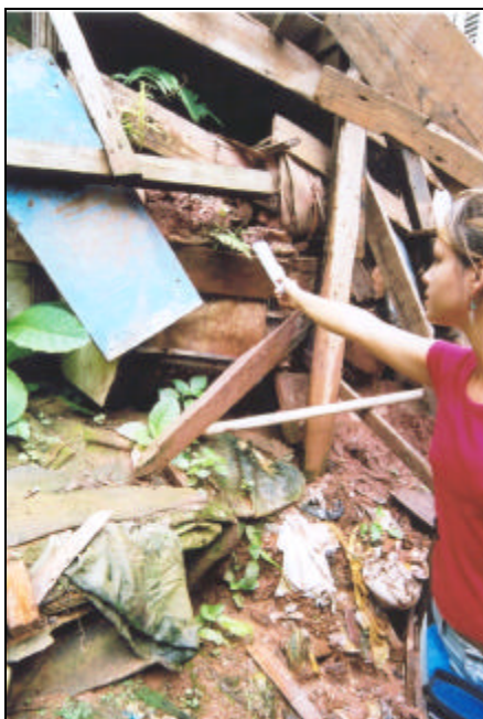
Foto 01 – Aterro lançado, contido por madeira, duas semanas antes do seu colapso.
