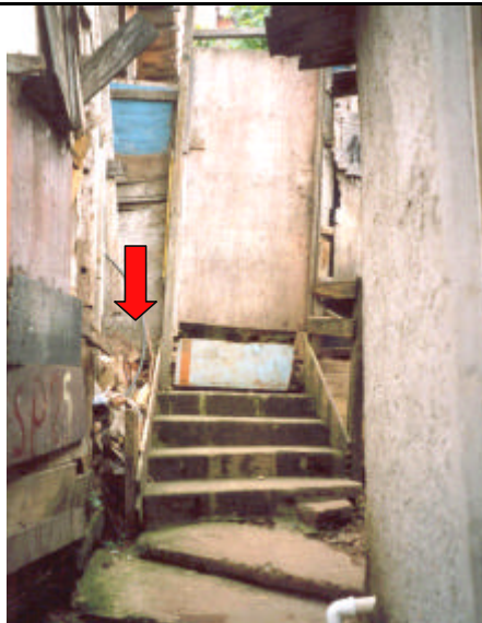
FC-RP-07 - Detalhe do acúmulo de lixo e entulho. Observa-se a presença de pavimentação e a ausência drenagem superficial.
