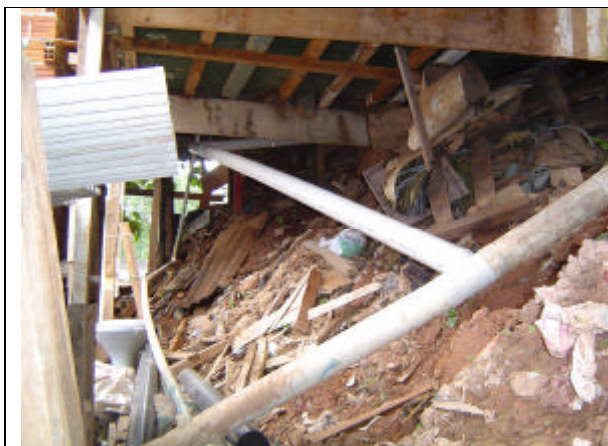
FCT-RP-03b – Detalhe do depósito de lixo e entulho sobre o depósito de solo lançado. O rastejo constante deste depósito já resultou na destruição de duas moradias que se encontravam construídas sobre este.
