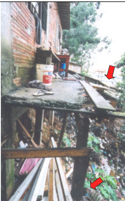
FC-RP-22b - Detalhe de uma das moradias localizadas no topo do talude, a qual já foi atingida por um escorregamento. Observar parte do desabamento ocorrido na frente da moradia e a situação precária em que se encontra a fundação da mesma.
