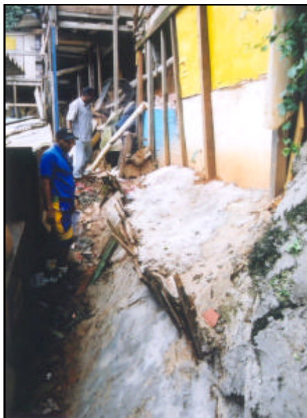
Foto 15 – Detalhe de uma intervenção realizada pelos moradores sem acompanhamento técnico.
