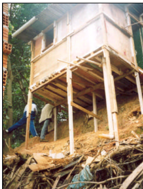
Foto 09 – Moradia construída sobre talude de corte localizado no quadrante sudoeste, entre as ruas Paulo Bourroul e Conde de Itaguaí.
