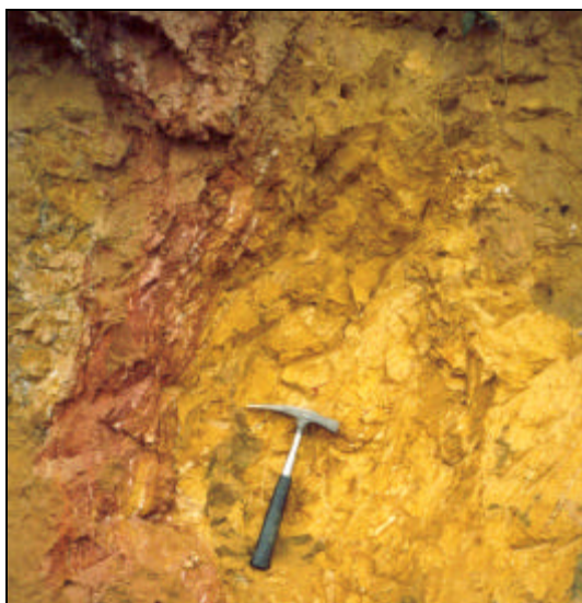
Foto 05 – Detalhe de um talude de corte expondo o solo saprolítico, resultado da alteração do gnaisse migmatítico.
