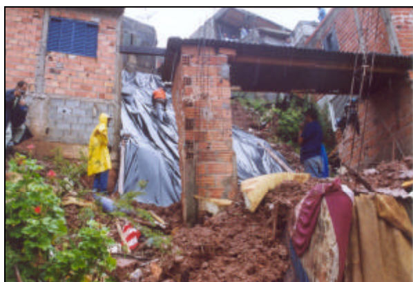
Foto 19 – A moradia localizada em um assentamento precário no município de Taboão da Serra foi completamente destruída.
