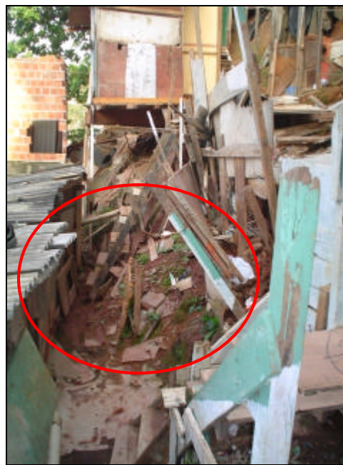
Foto 02 – Vista do aterro colapsado. Obs.: Notar volume de material mobilizado circulado em vermelho.
