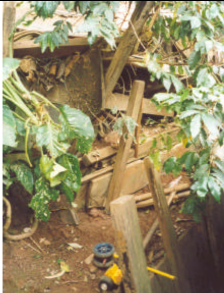
FC-RP-20 - Talude de corte, quase vertical, escorado por tábuas e caibros de madeira. Na base deste talude há uma moradia, a qual apresenta embarrigamento e diversas trincas na parede dos fundos.
