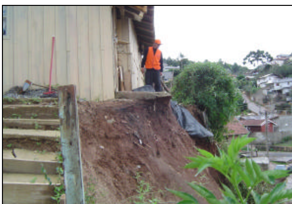
Foto 17 – Detalhe de uma ruptura em aterro ocorrida no município de Campos do Jordão.
