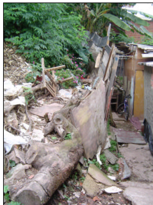
Foto 14 – Observar o embarrigamento de uma contenção de madeira devido ao empuxo causado pelo material mobilizado por escorregamentos pretéritos, além do lixo e entulho.
