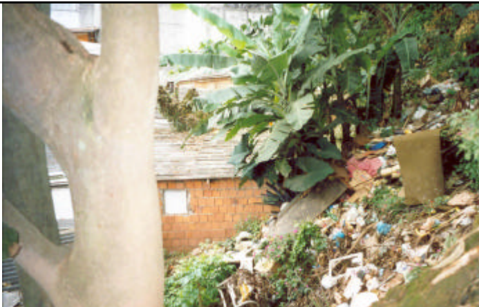
FC-RP-16 - Vista geral dos fundos de uma moradia localizada na base do talude de corte descrito no ponto 1. Observar a proximidade da mesma em relação a base talude e a grande quantidade de lixo e entulho, além da presença de bananeiras.
