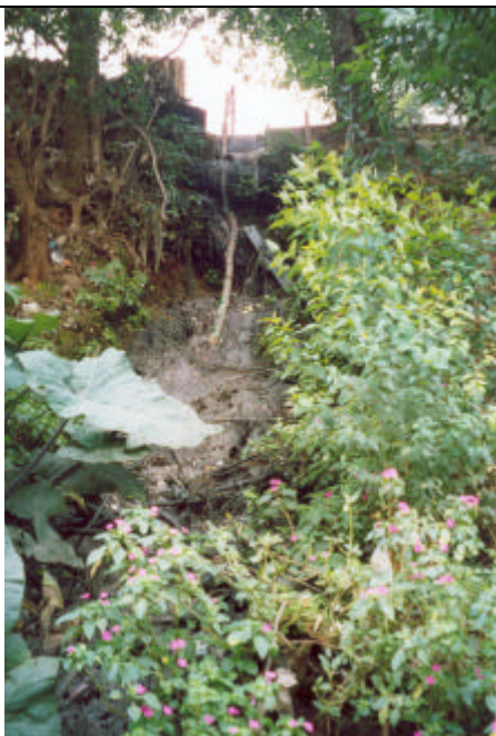
FC-RP-01a - Detalhe de uma cicatriz de escorregamento localizada na porção média do talude. Observar que a cabeceira da cicatriz se inicia no ponto onde um cano de PVC verde esgoto e água servida.
