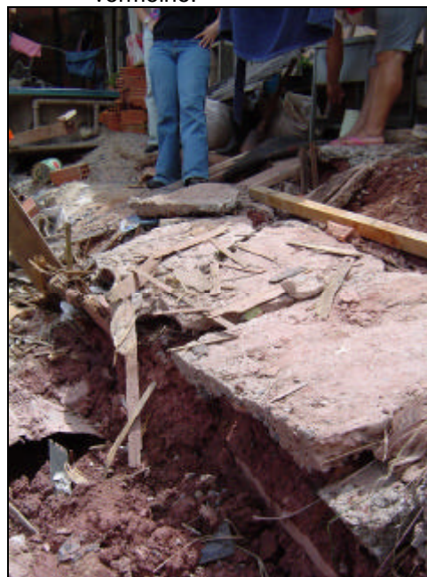
Foto 04 – Detalhe do aterro de pequenas dimensões, colapsado devido a inexistência de compactação, a saturação pelas chuvas e a carga gerada pela construção da moradia sobre ele.
