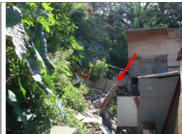
FCT-RP-02b - Vista parcial dos depósitos de solo lançado, localizados na base do talude de corte, atingindo até 6m de altura. Notar ao fundo a tentativa de conter a movimentação dos depósitos com placas de madeira, as quais encontram-se inclinadas.
