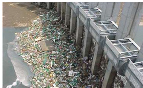
Acúmulo de lixo e esgoto sanitário em reservatório de amortecimento (piscinão) – São Paulo.
