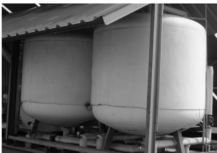
Figura 5.19 – Acumuladores de Água.
