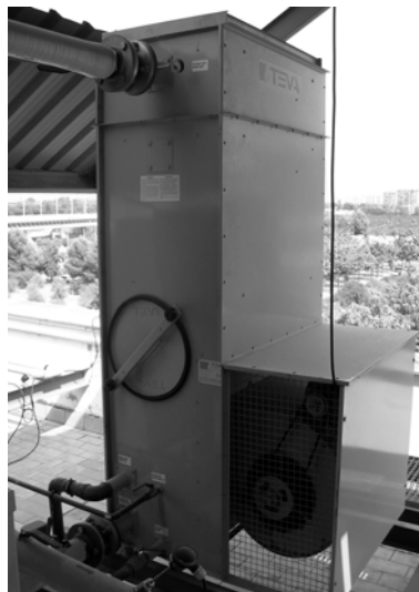
Figura 5.21 – Torre de Resfriamento.
