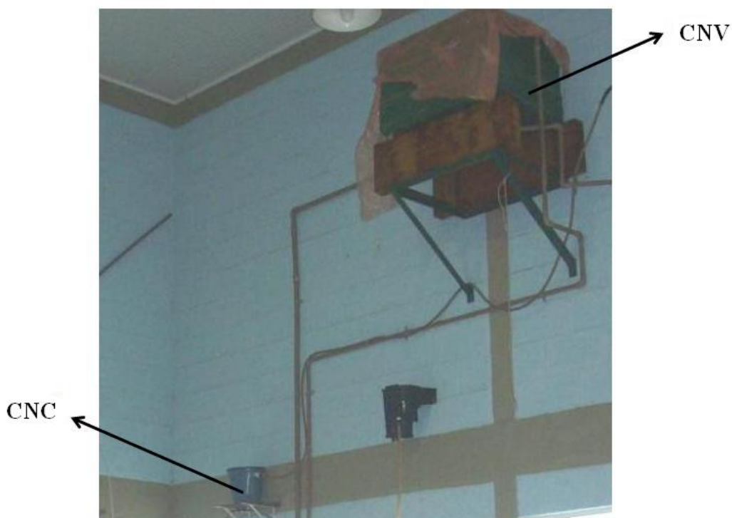
Figura 12 – Reservatório de água bruta de nível constante (CNC) e reservatório de água bruta de nível variável (CNV)
