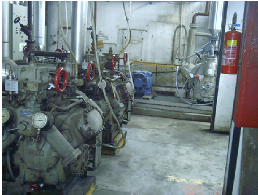
Figura 3 – Visualização da área final da sala de máquinas
