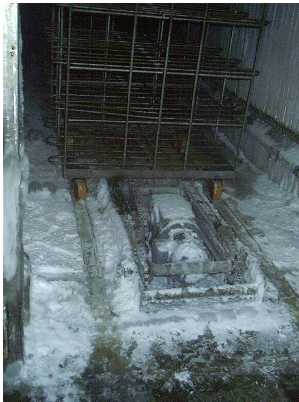
Figura 23 – Túnel de congelamento
