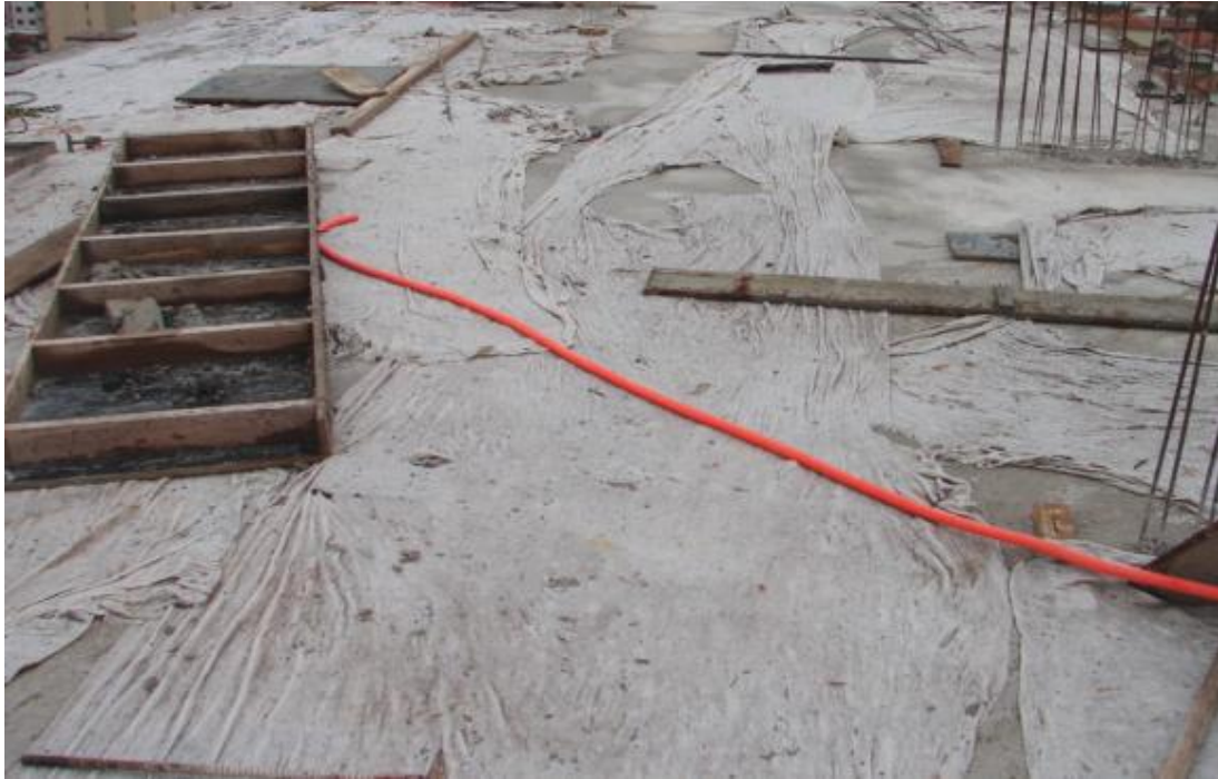
Figura 67 - Pavimento não coberto por completo, comprometendo a cura adequada
