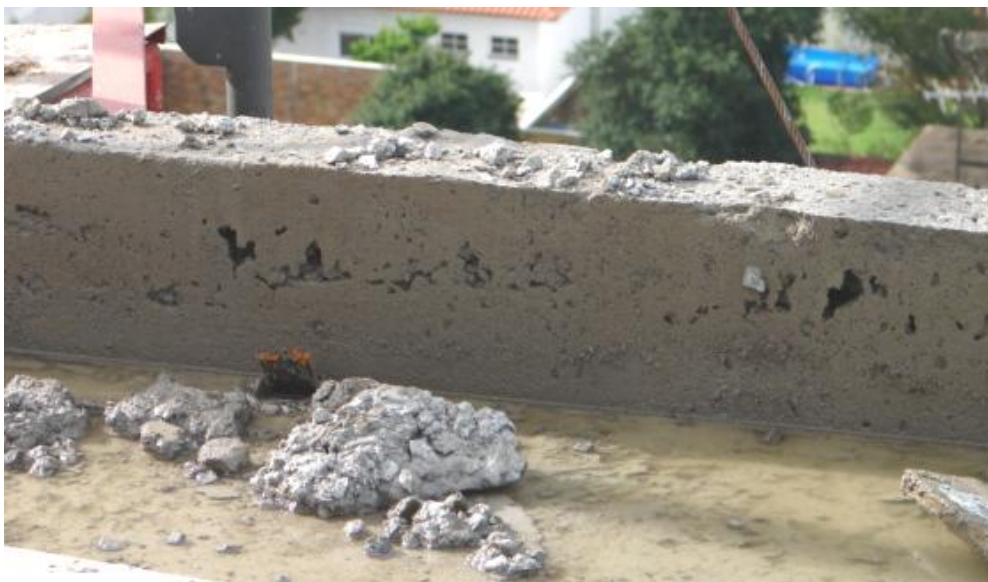
Figura 63 - Vibração do concreto inadequada que ocasionou 'bicheiras'
