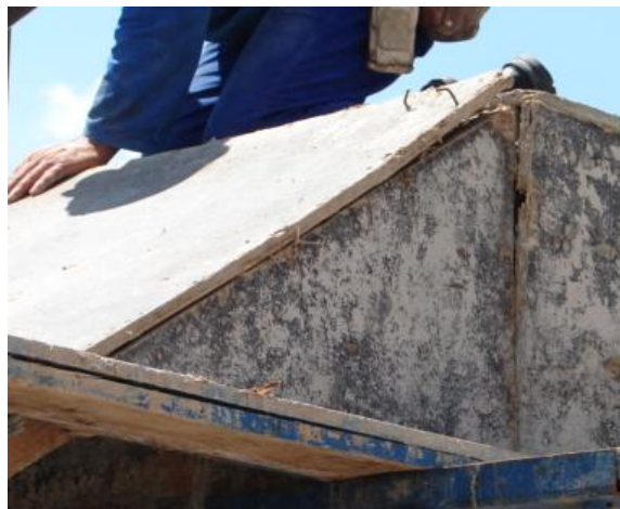
Figura 26 - Fôrma danificada pelo uso inadequado
