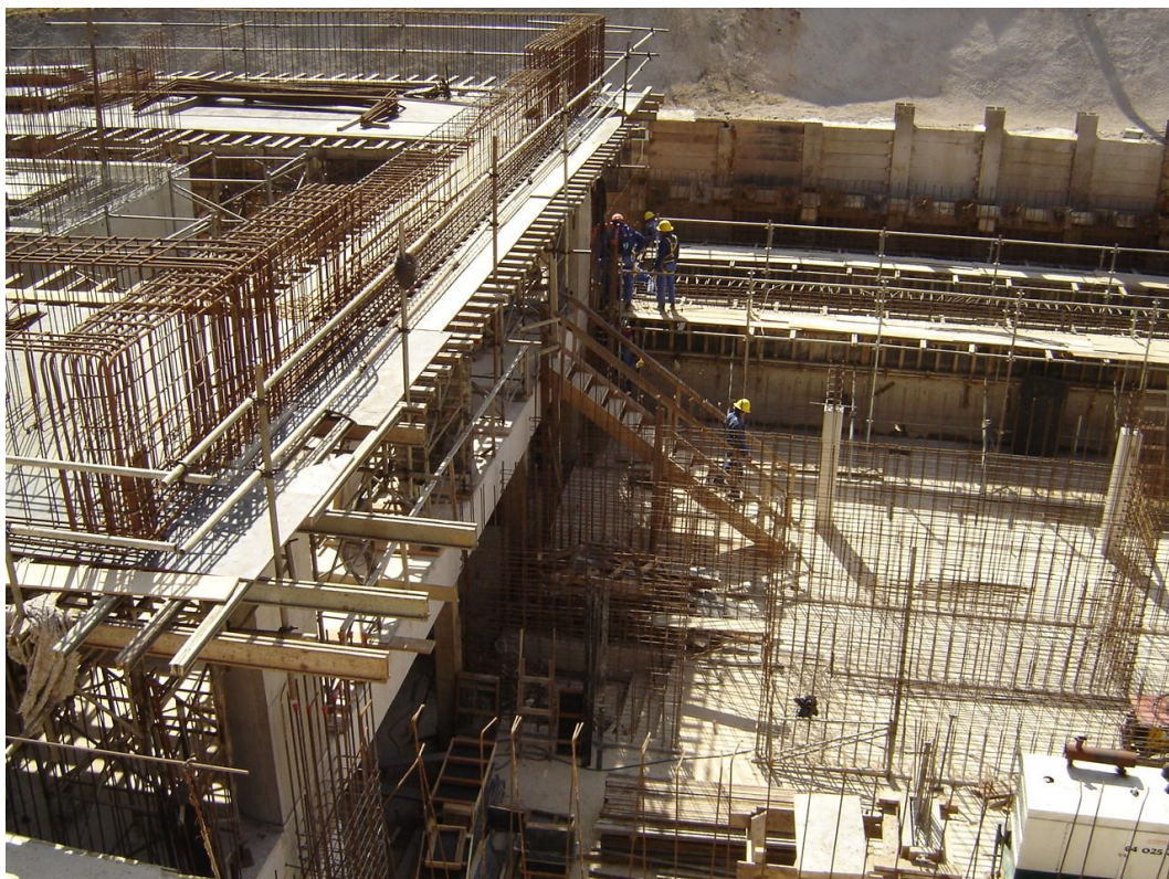
Figura 10 - Esquema geral de um canteiro com o devido caminho para passagem de materiais, pessoas e equipamentos
