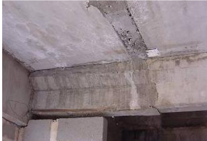
Figura 15 - Desnível da viga Fonte: ALVES, et al. , 2006
