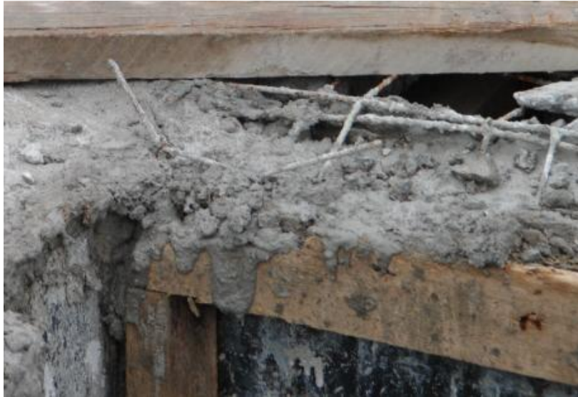
Figura 48 - Armadura exposta após a concretagem
