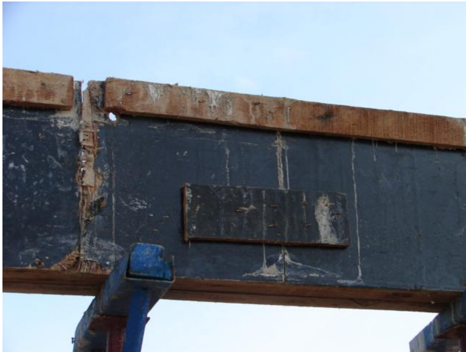
Figura 36 - Fôrma de pilar danificada por manuseio incorreto e estocagem inadequada
