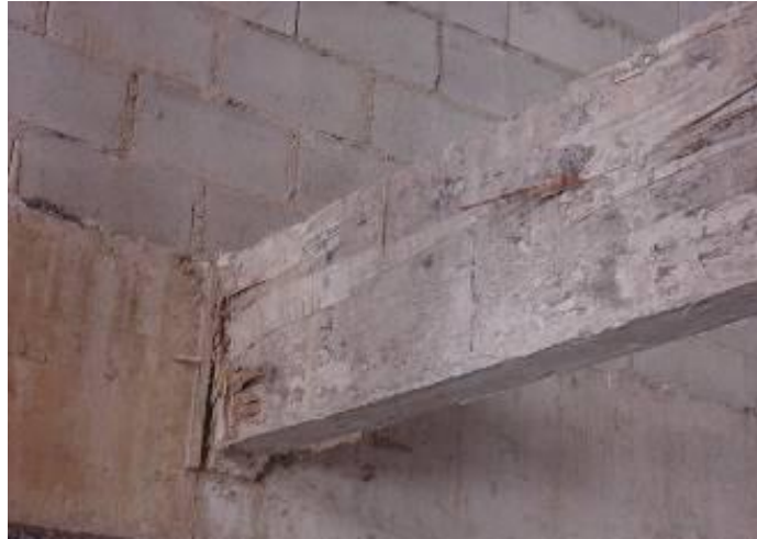
Figura 21 - Fragmentos de fôrmas incorporados Fonte: ALVES, et al , 2006
