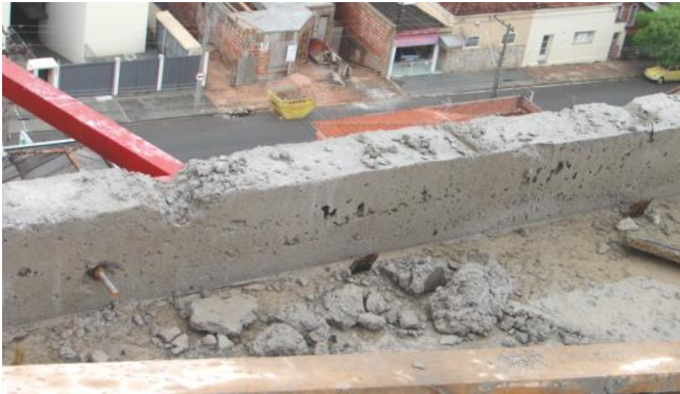
Figura 62 - Adensamento não feito de maneira correta ocasionando 'bicheiras'
