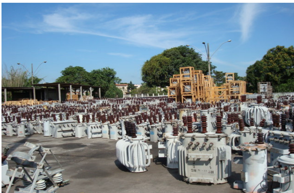
Figura 11 – Transformadores para manutenção Fonte: www.intranetempresaWZ.com.br
