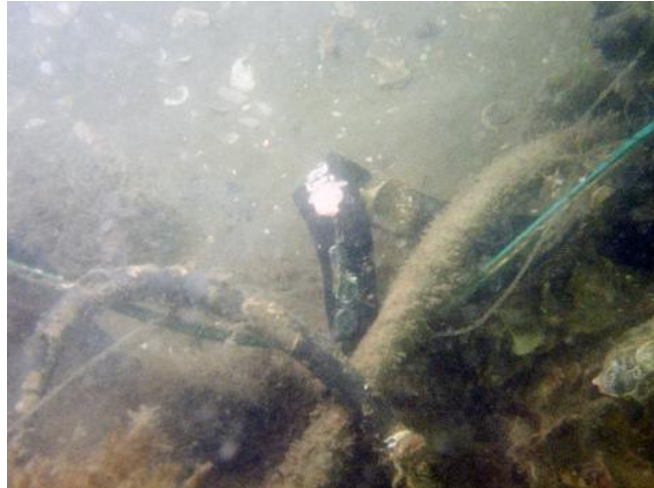
Imagem 41 – Cabos de energia. Foto: Glória Tega
