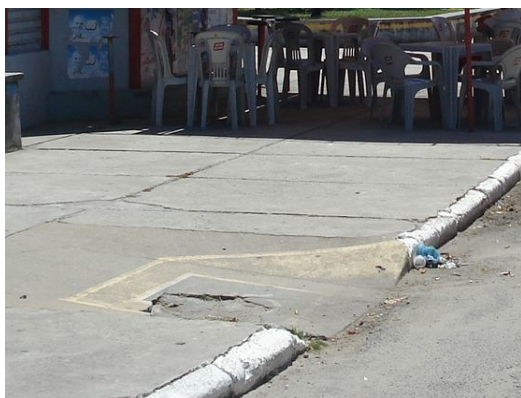
Figura 90: Rampas para P.D com rachaduras Fonte: Silva, C. F. R da - Pesquisa de Campo, 2009
