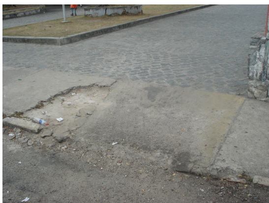
Figura 35: Estado de conservação das rampas de acesso Fonte: Silva, C. F. R da - Pesquisa de Campo, 2009
