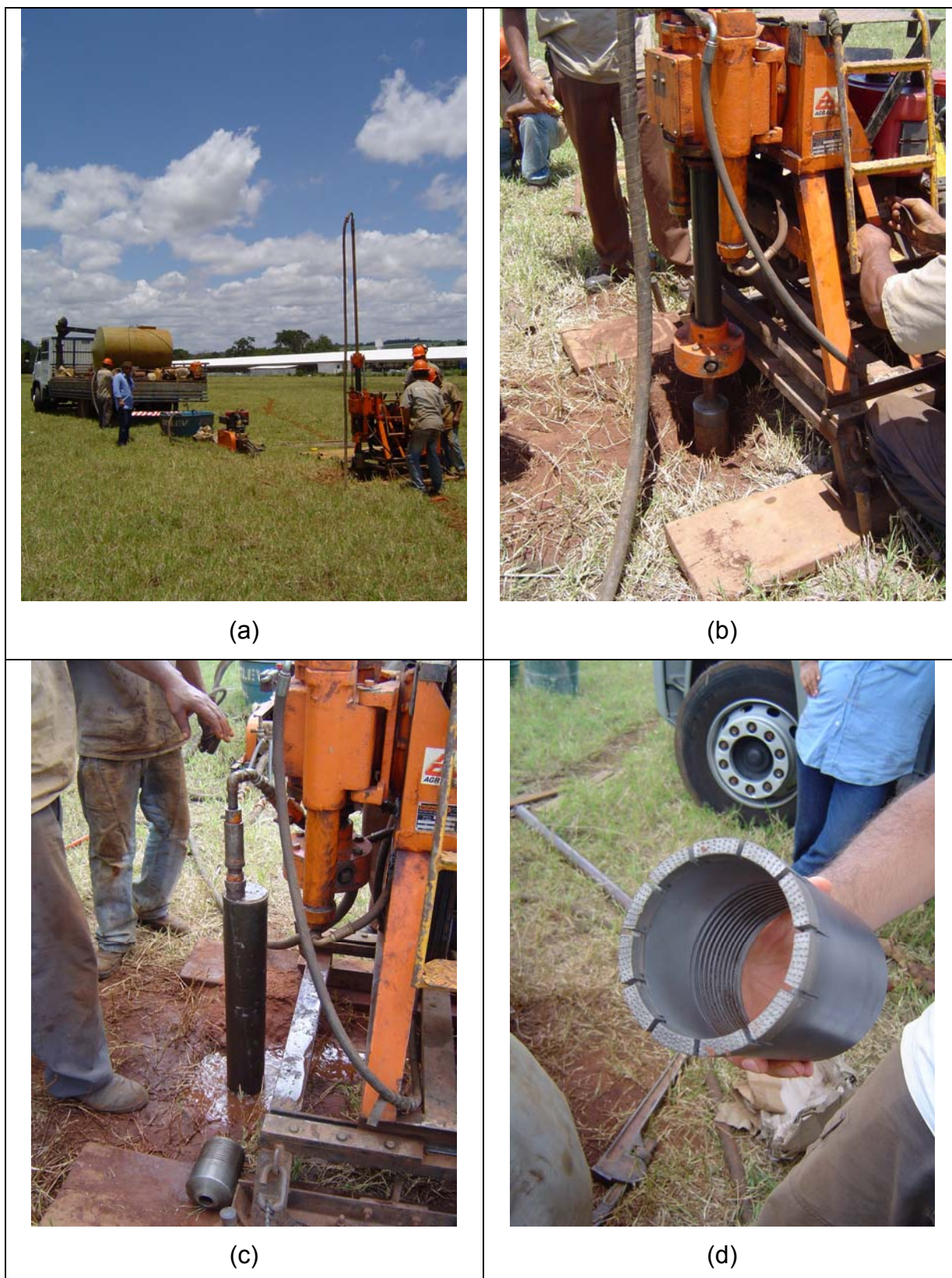
Figura 123 – (a) arranjo dos equipamentos para a sondagem rotativa; (b) perfuração a seco; (c) perfuração com fluido de perfuração; (d) coroa diamantada de perfuração de 4 pol. de diâmetro.
