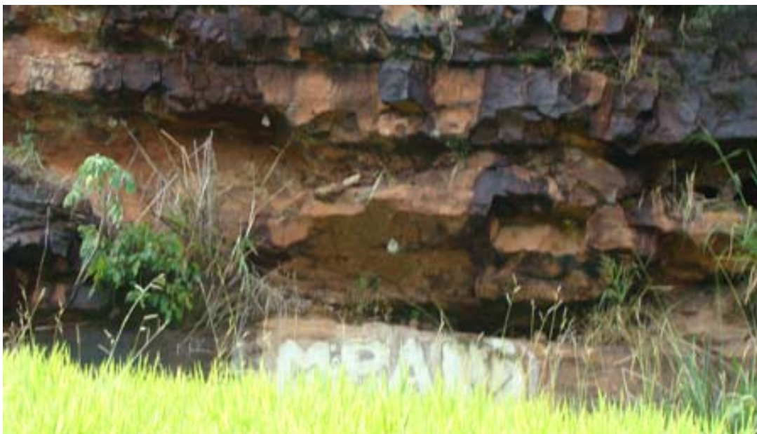
Figura 61 – Detalhe das descontinuidades.
