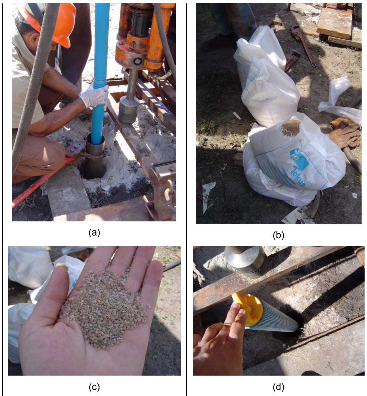
Figura 124 – (a) Colocação da tubulação; (b) embalagem do pré-filtro; (c) pré-filtro; (d) espaço anelar para preenchimento com o pré-filtro.
