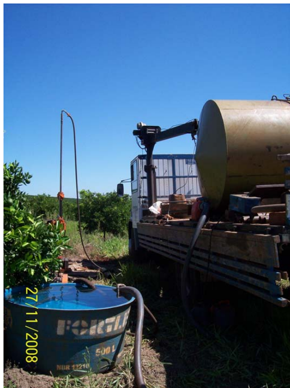
Figura 122 - Depósito de água com qualidade adequada à realização do poço de monitoramento.
