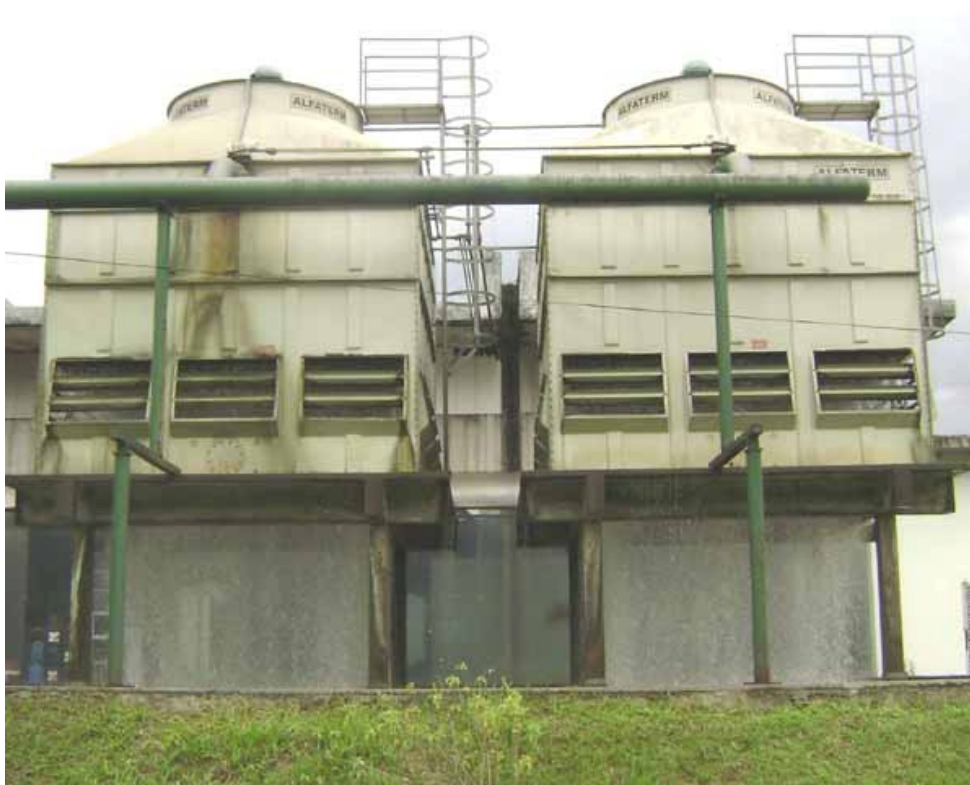
Figura 17 - Torres de resfriamento de água da central de água gelada
