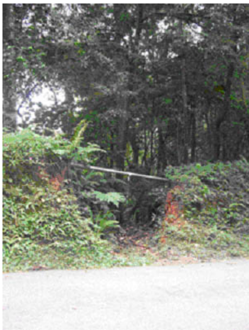
Fotografia 9 – “Sangra” de Drenagem das Águas de Superfície no Piso da Trilha da Pedra Grande – Parque Estadual da Cantareira – Município de São Paulo
