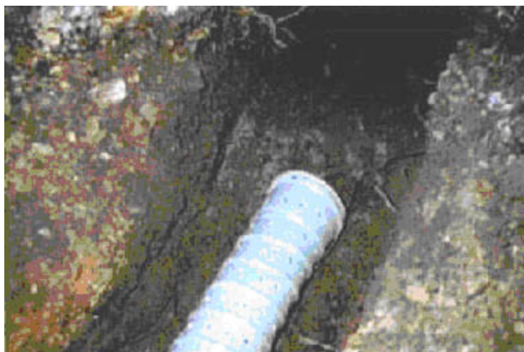
Fotografia 8 – Tubo de Drenagem de Subsuperfície do Piso da Trilha da Capivara – Parque Nacional de Brasília – Distrito Federal Fonte: Horowitz, C. (2001)
