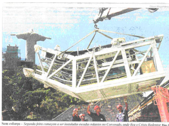
Fotografia 18 – Aspecto dos Trabalhos de Instalação da Escada Rolante de Acesso ao Monumento do Cristo Redentor – Parque Nacional da Tijuca – Município do Rio de Janeiro
